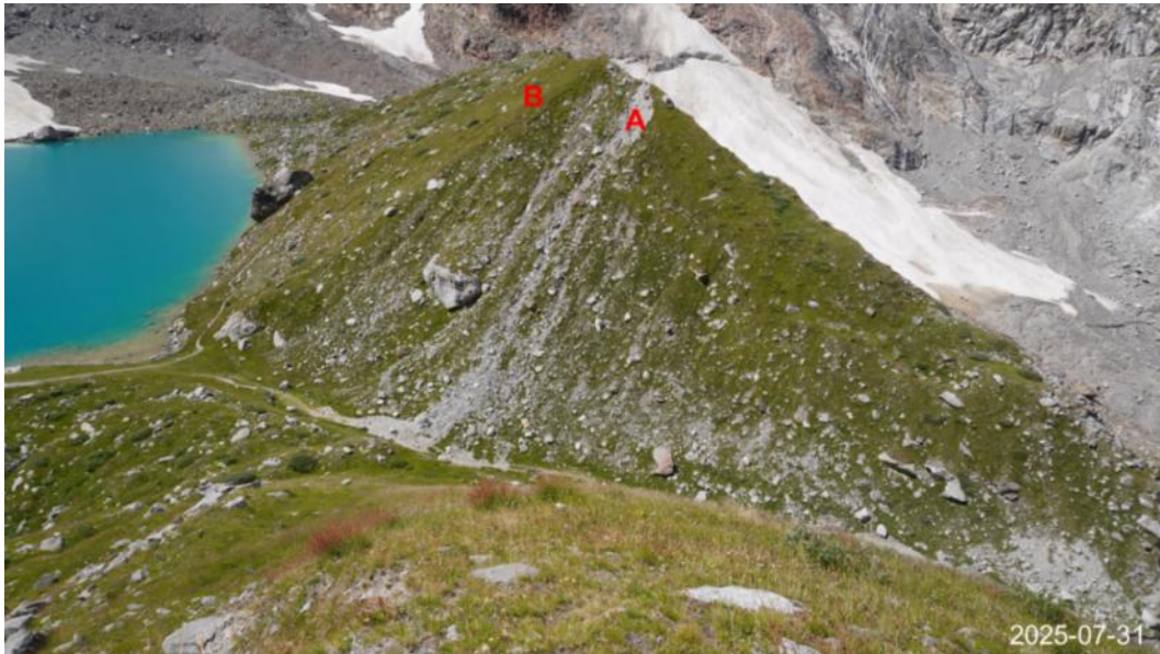
Figura 75 – Fianco meridionale dello scaricatore artificiale del lago delle Locce (foto W. Alberto, 31/07/2025): (A) erosioni superficiali; (B) rottura della cotica erbosa. Sul lato esterno della morena, prosegue l'evoluzione della scarpata di frana che la interessa ormai da circa 20 anni. Rispetto all'anno scorso, l'arretramento è di ordine metrico, esponendo sempre più la condotta di scarico del lago delle Locce (Figura 77).
