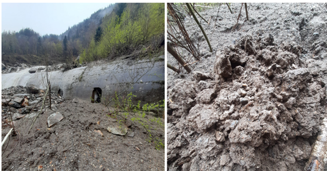
Figura 4.9: Accumulo della valanga mista a detrito che ha interessato il paravalanghe sulla statale che porta a Macugnaga. Sulla destra un particolare dell'accumulo dove è ancora ben visibile la parte nevosa mista a detrito, (Foto CLV valle Anzasca)
