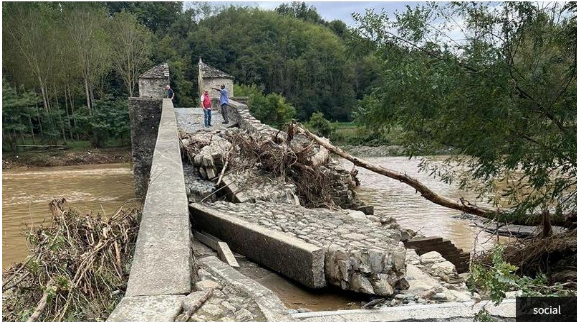
Figura 31 – Il ponte medievale di San Rocco a Spigno Monferrato danneggiato dalla piena. (Fonte https://www.rainews.it/tgr/piemonte/articoli/2025/09/maltempo-ancora-nessuna-traccia-della-turista-tedesca-dispersa-4387382c-6e1c-42de-aadd-080a87c7be79.html )
