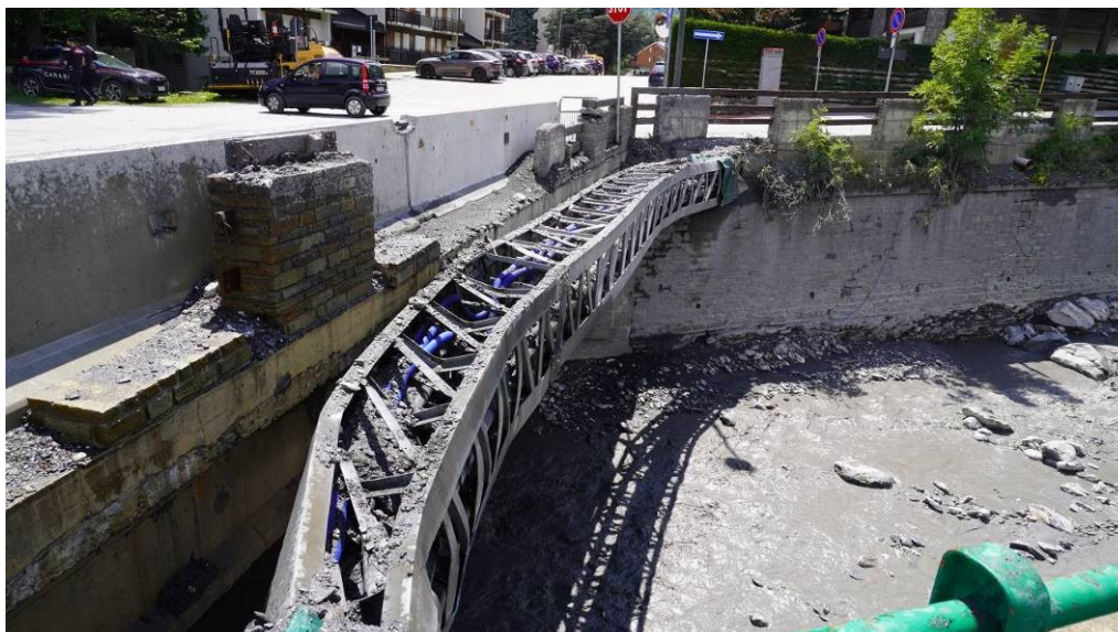
Figura 24 – Lungo il lato di monte del ponte di via De Gasperi sono visibili i sottoservizi già danneggiati nel 2023.
