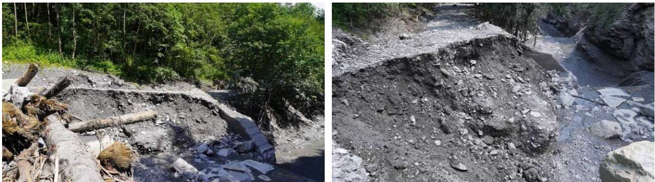
Figura 18 – Erosione in sponda in sinistra del T. Frejus in corrispondenza della briglia selettiva a quota 1380m, l'erosione ha causato l'interruzione della strada sterrata.
