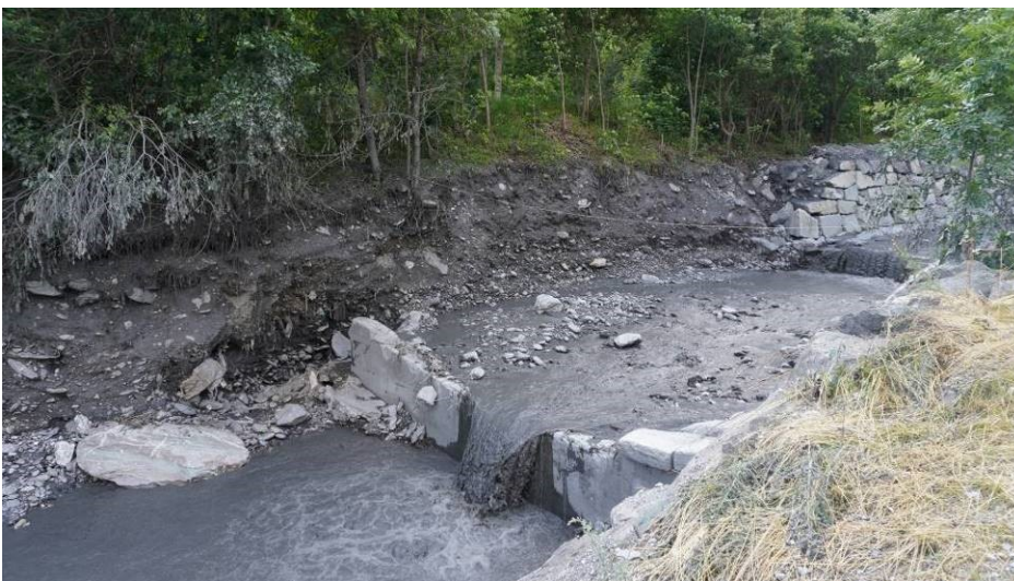
Figura 22 - Erosioni in sponda destra e sinistra del rio Frejus in apice del conoide.
