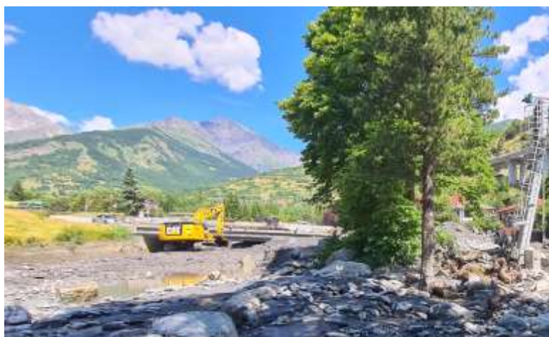
Figura 34 – Il ponte che porta alla casera dei VVFF è stato completamente occluso e sormontato.
