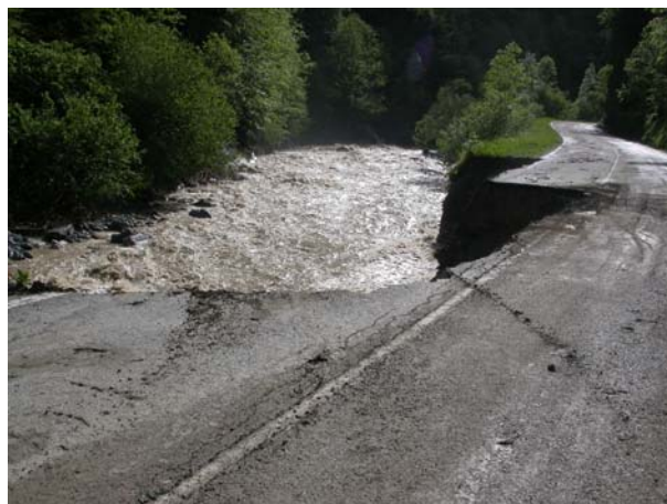
Foto 3. Strada danneggiata lungo la S.P. nel comune di Castelmagno
