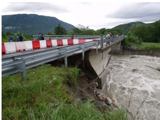
Sottoescavazione del rilevato di accesso al ponte in località Erasca nel comune di Paesana
