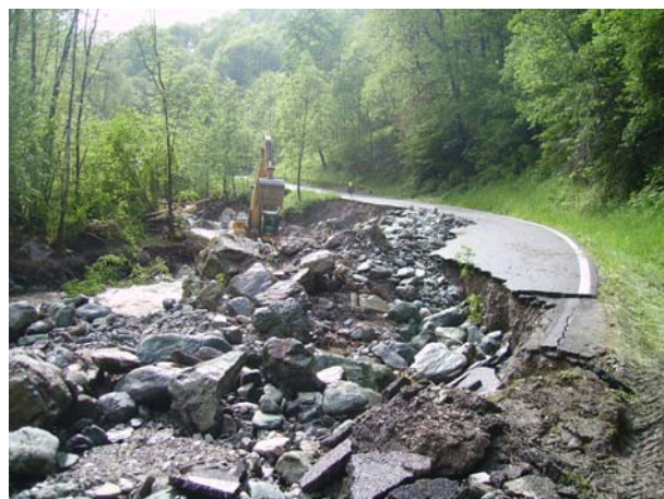
Strada del vallone di Frise interrotta per erosione spondale nel comune di Monterosso Grana
