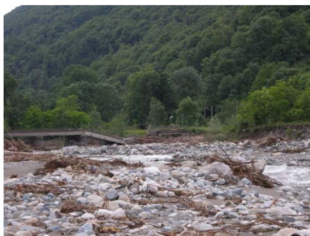
Tratto del Ponte Albertenga crollato verso la sponda destra (ripresa da monte)
