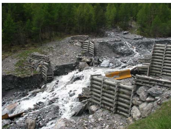
Briglie danneggiate lungo il Torrente Rho nel comune di Bardonecchia
