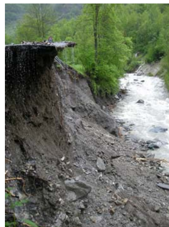
Scarpata di circa 20 m a spese del corpo stradale della S.P del bivio per Salza ad opera del Torrente Germanasca
