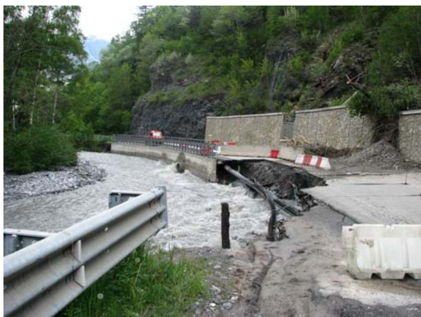
Erosione di sponda lungo la S.S. 335 nel comune di Bardonecchia
