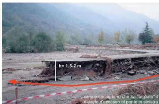
Viabilità di accesso al Ponte Albertenga a Torre Pellice asportata nel corso dell'evento dell'ottobre 2000
