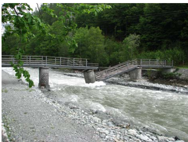
Crollo del Ponte Ramassere nel comune di Usseglio
