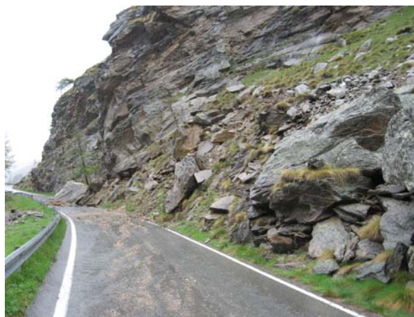
Crollo e scivolamento di massi lungo la S.P. del Nivolet nel comune di Ceresole Reale
