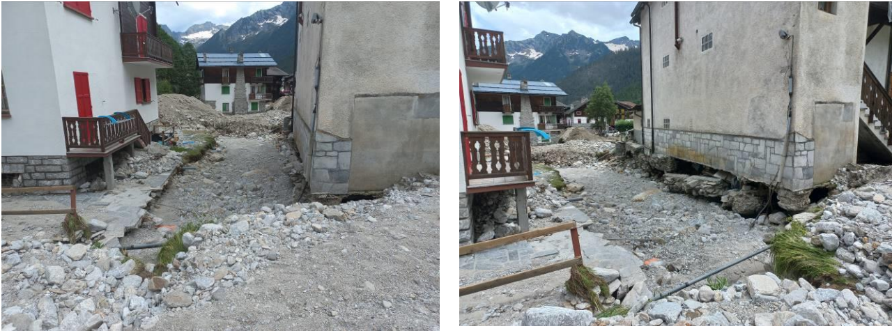
Figura 40 - Deviazione dell'alveo del T. Tambach tra le prime abitazioni a sud del piazzale della funivia Passo Moro; l'erosione ha scalzato parzialmente le fondazioni delle abitazioni (Foto: Regione Piemonte, Settore Tecnico NO-VB).
