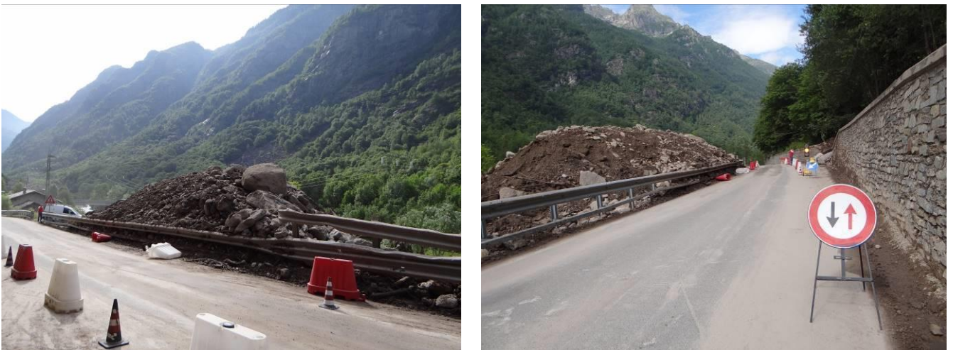
Figura 30 - Il materiale detritico che ha invaso la sede stradale è stato ricollocato oltre il guard-rail per ripristinare la circolazione. A sinistra, vista da monte verso valle; a destra vista da valle verso monte.
