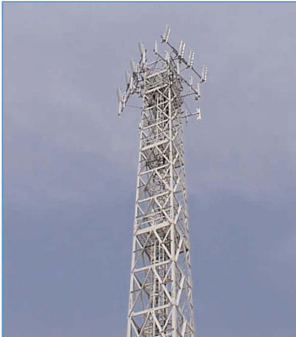
Fig. 2 Stazione radio base per telefonia mobile.
