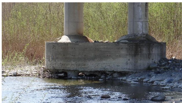
Pila del ponte Garaglia-Francavilla Bisio sottoescavata
