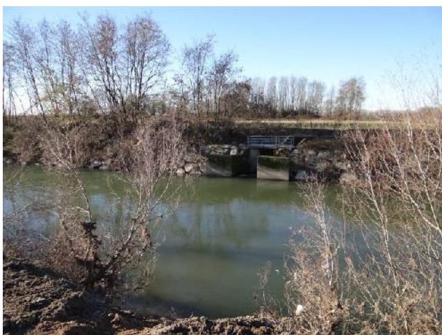
L'uscita dello scaricatore di cavo Panizzina.
