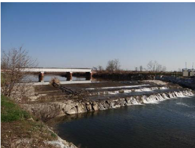
Traversa di derivazione Roggia Mora.
