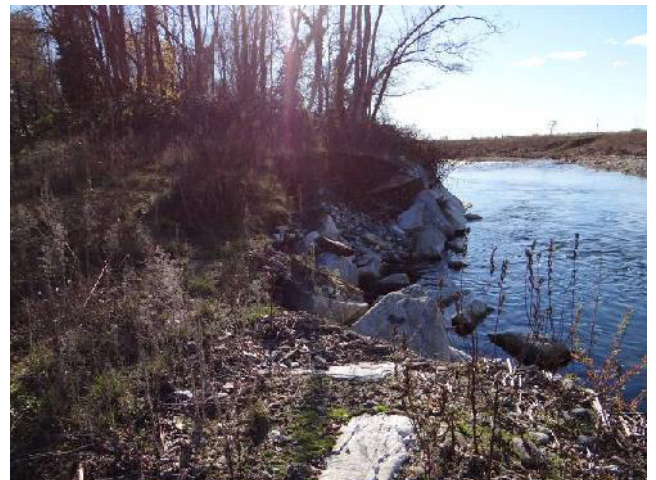
Erosione di difese spondali nella stessa località.
