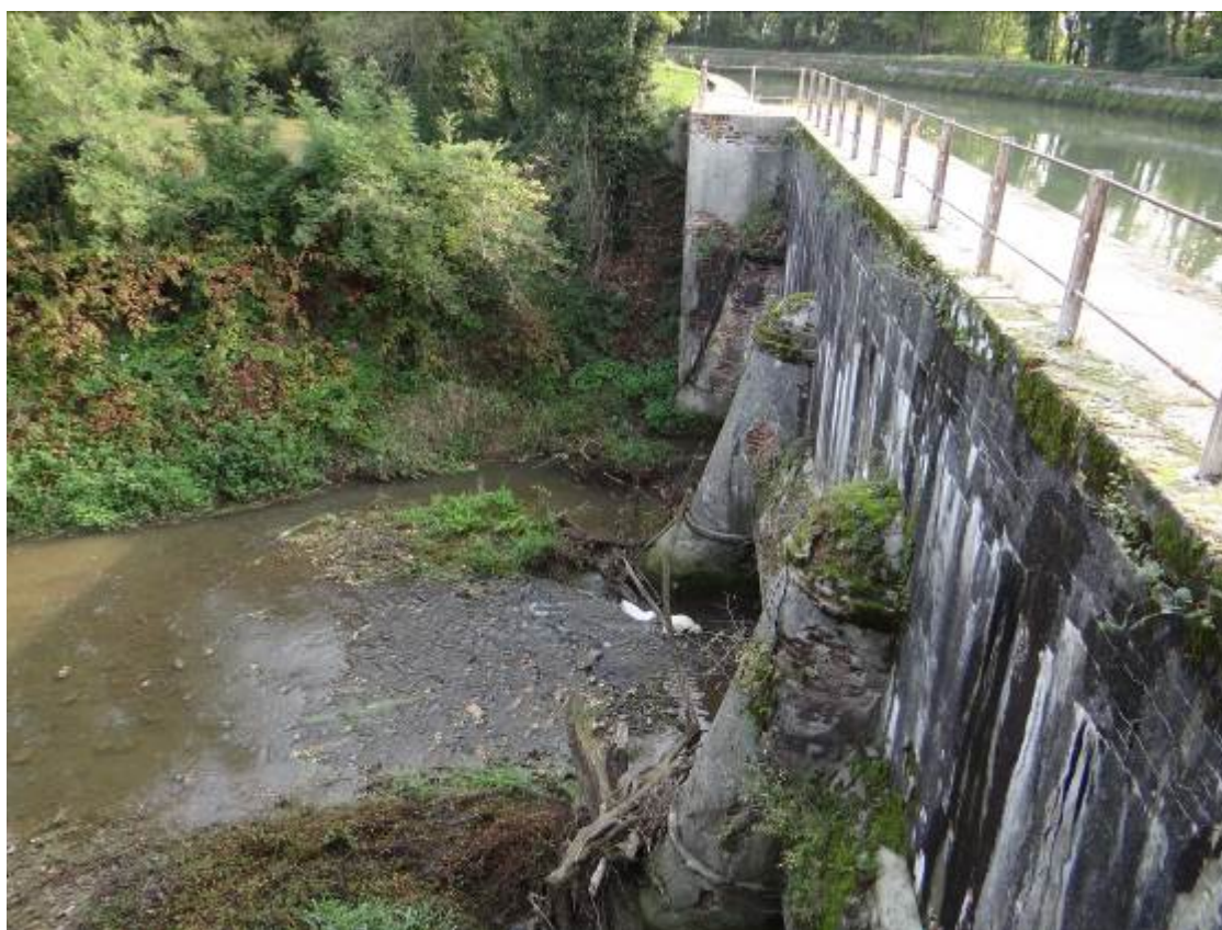
Figura 3 Il canale Cavour attraversa l'alveo nel tratto 5 con un ponte che riduce fortemente il flusso di sedimenti e materiale legnoso.
