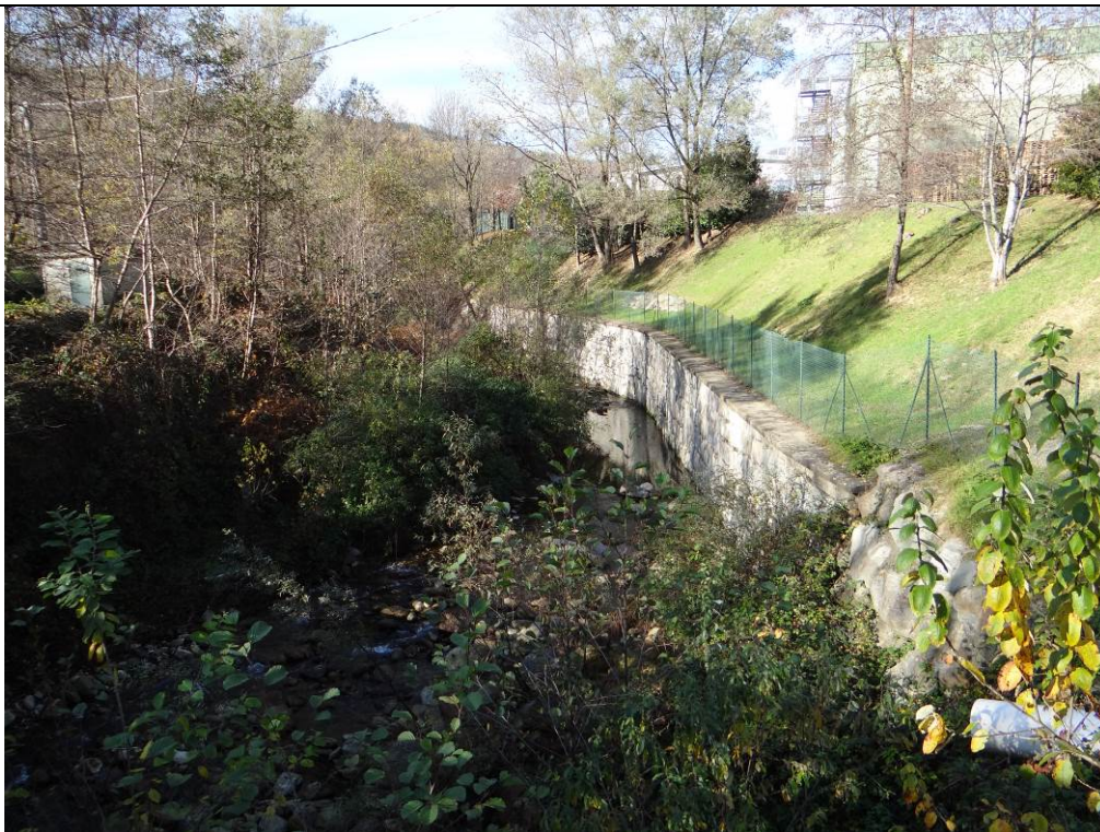
Figura 1. Difese spondali in corrispondenza della ditta Alpe Guizza, tratto 4.
