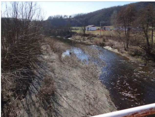
Alveo a monte del ponte di Merana.
