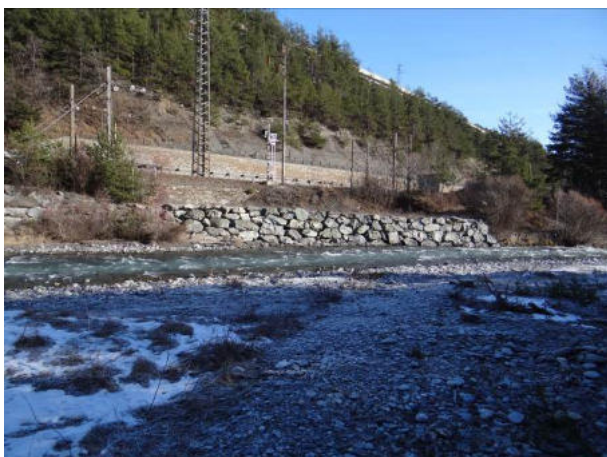
Alveo a monte di Beaulard. Difesa in blocchi in sponda sinistra, dietro la quale è visibile il rilevato ferroviario
