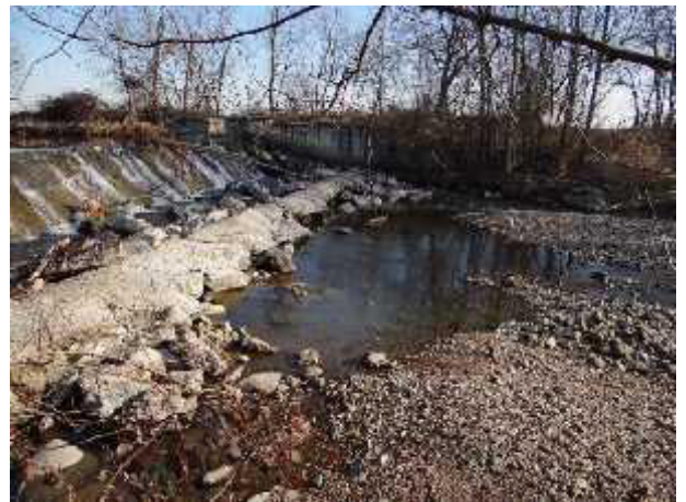
Erosione del fondo alveo subito a valle della traversa
