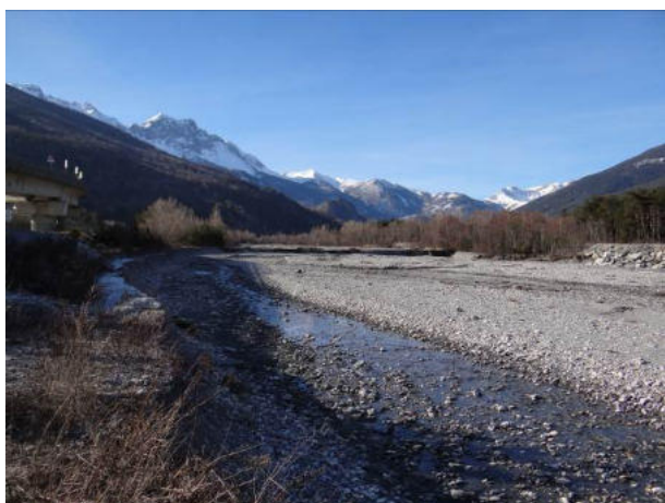
Alveo in corrispondenza del Villaggio Pra Long visto verso monte, sponda destra erosa, sponda sinistra con difesa in massi, in fondo visibile una delle soglie colmate che si susseguono a monte del casello di Oulx.
