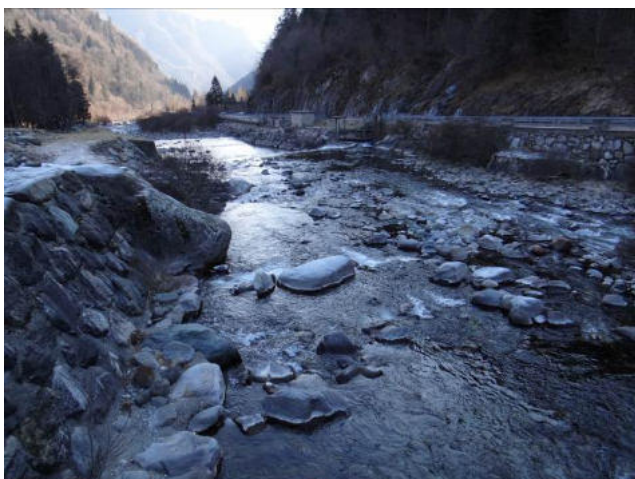
Difese su entrambe le sponde in corrispondenza di Località Montelavecchia.
