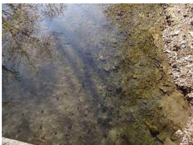
Particolare del fondo alveo con clogging all'altezza del ponte SP 113.
