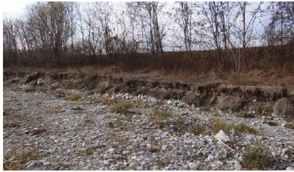
Erosione in sponda sinistra nei pressi di T.to Frassinetto.
