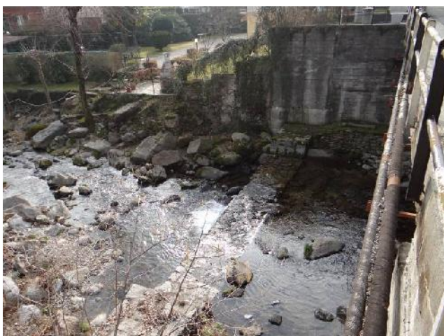
Soglia a protezione dell'opera di attraversamento.
