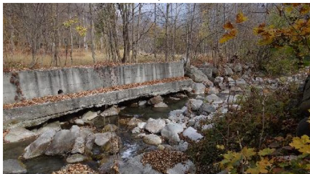
Sottoescavazione difese in sponda sinistra
