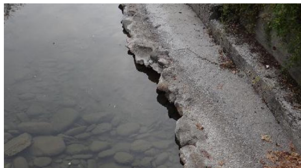
Dettaglio platea con lieve sottoescavazione..
