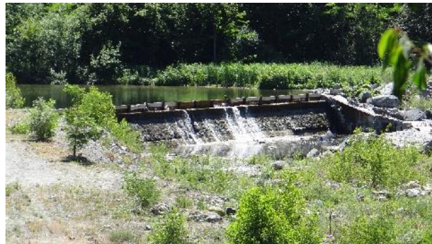
Traversa per prelievo idroelettrico
