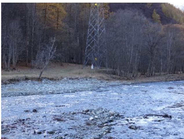
Erosione in sponda destra di fronte a Chiaberto
