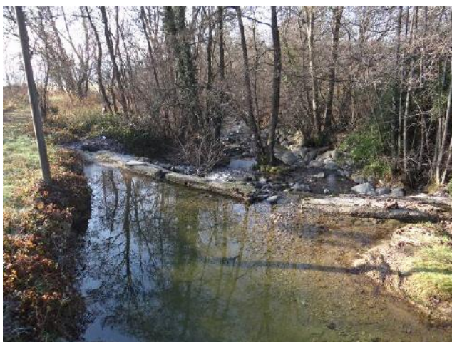
Traversa danneggiata a monte del tratto
