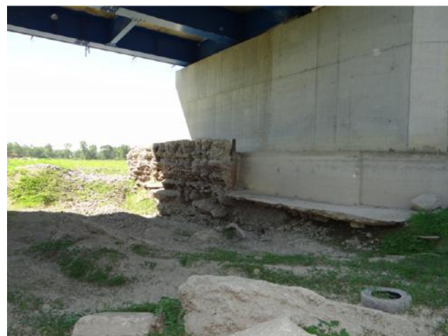
Particolare di una pila sottoescavata.
