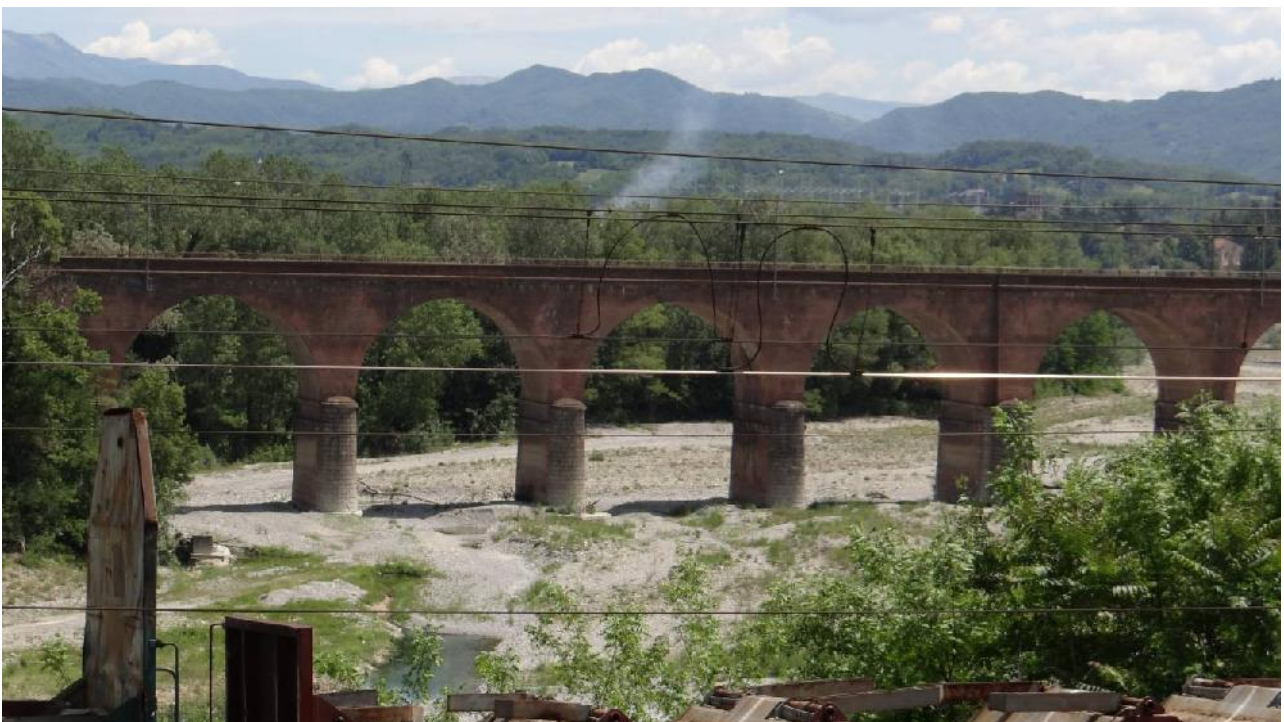
Ponte ferroviario, localmente si rilevano effetti di sovralluvionamento
