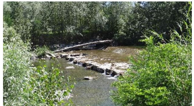
Traversa per prelievo idroelettrico
