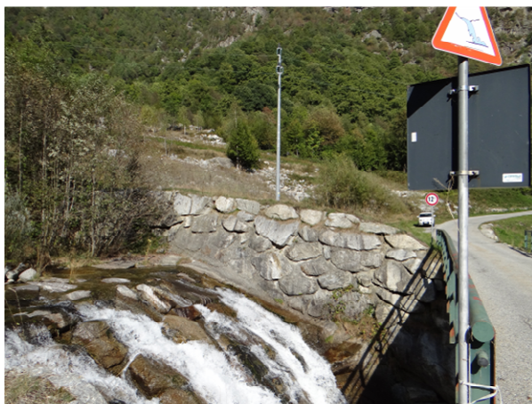
Il tratto di alveo, a monte e a valle del ponte è alterato per la presenza di rivestimento del fondo impermeabile (pietrame e massi cementati) e le sponde sono difese.
