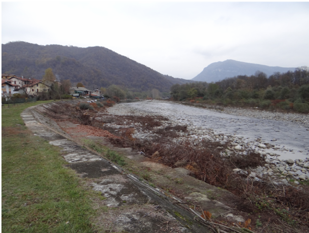
Loc. Guardella, argine in sinistra idrografica con repellenti
