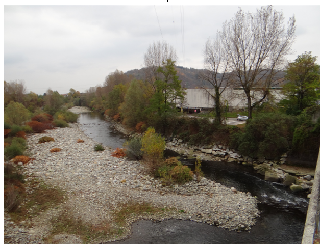
Accumulo sedimenti a valle della soglia e difesa spondale in destra idrografica sottoescavata
