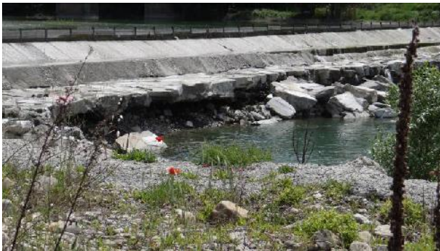
Traversa di Varinella: sottoescavazione per erosione del fondo
