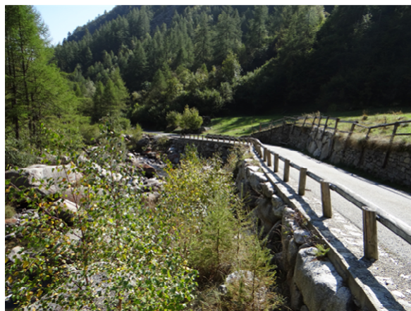
Difesa spondale in destra in località Ronco.
