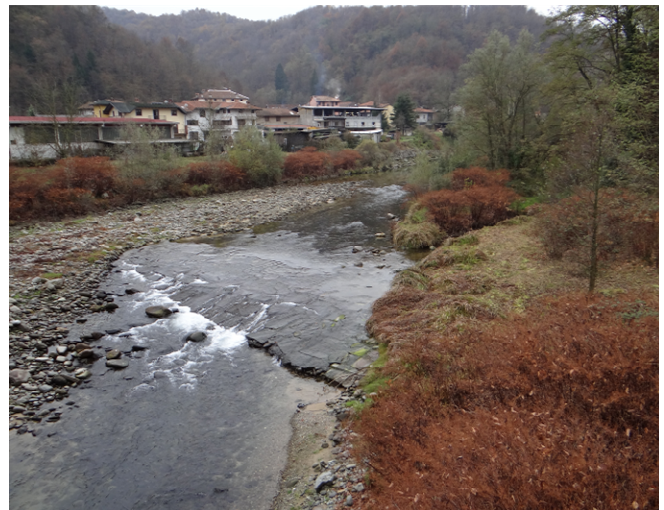
Soglia a monte del ponte Pianceri quasi interamente sepolta dai sedimenti e sponda idr. destra difesa
