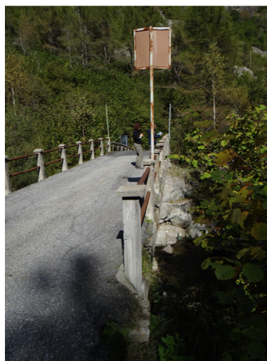
Ponte tra Ronco e S. Giacomo la pila in sinistra e un argine a monte chiudono un vecchio ramo del torrente.
