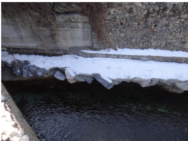
Sottoescavazione difese in sponda destra
