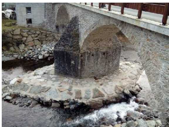
Ponte in località Il Dazio con grossa pila interferente
