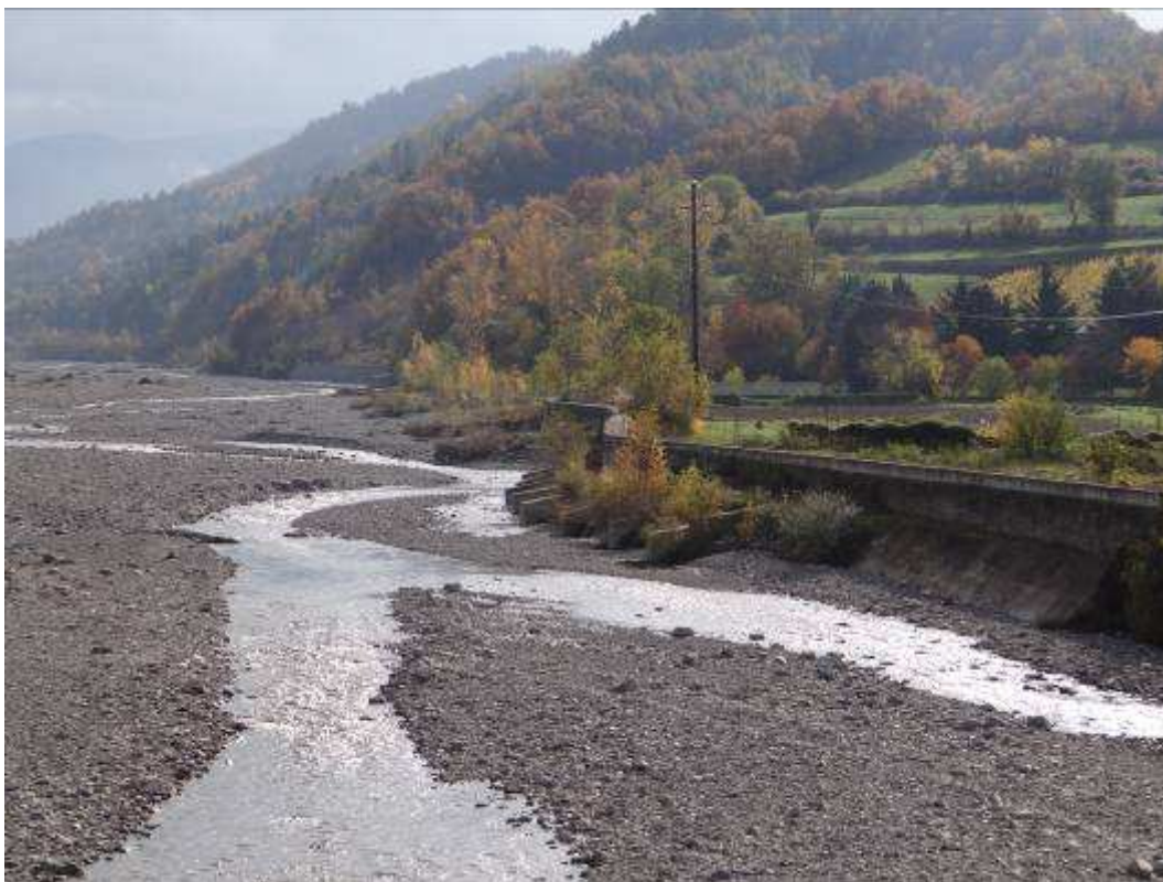
Figura 7 – Difese spondali in sponda sinistra a monte del ponte per Rocchetta Ligure
