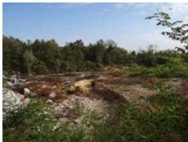
Vista a valle dell'opera, erosione con esposizione del substrato.
