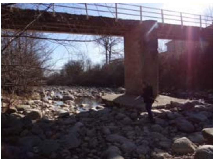
Pila del ponte parzialmente scalzata
