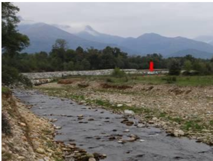
Soglia (freccia in rosso) con estese opere di difesa spondale sia in destra che in sinistra idrografica in loc. Minazia
