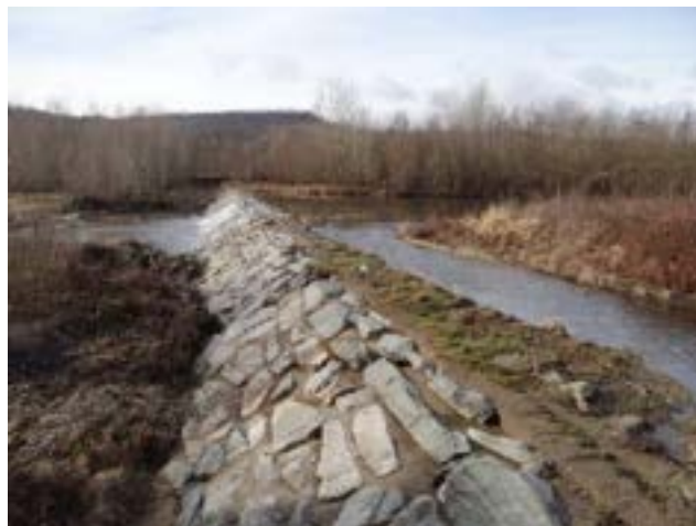
Traversa di derivazione in loc. C.ne Rivetti.
