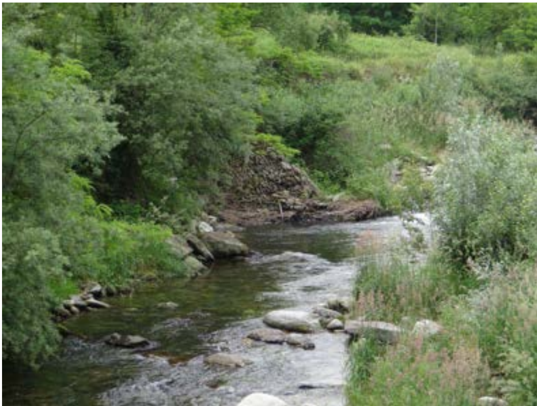
Figura 9 – Vecchie difese spondali ormai distrutte
