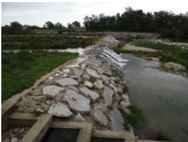
Soglia con vasche per la risalita dei pesci in loc. Minazia
