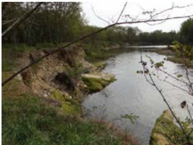
Erosione in sponda sinistra.
