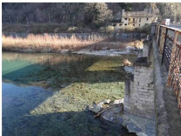
Pile parzialmente scalzate del ponte della Masone.
