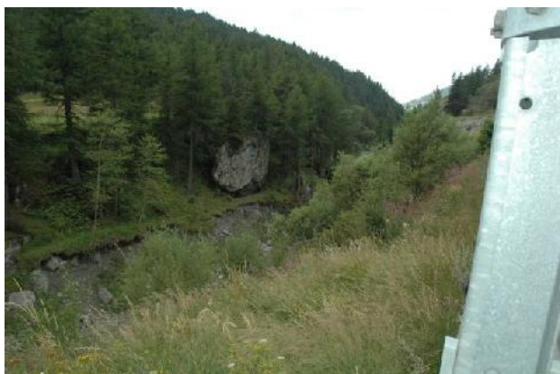
Sponda destra erosa vista dalla statale
