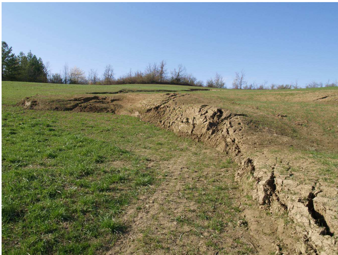
Fianco destro della frana nel settore basso, in prossimità del piede del fenomeno. Foto scattata il 14/04/2010
