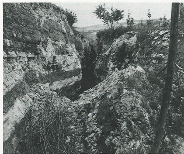
Fig. 4 - Particolare del fenomeno franoso prima del crollo del 1963. Una grossa frattura beante della quale si intuisce la profondità superiore ai 15 m, parzialmente occupata, in primo piano, da una zolla ribaltata (Archivio C.N.R.-I.R.P.I. Torino).
