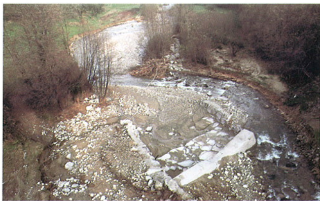
Fig. 40. Comune di Mongrando, loc. S.S. 419 Settimo-Vittone: vista dal viadotto dell'alveo del t. Viona, a monte della frazione Tana; la foto evidenzia le profonde erosioni laterali e la mobilitazione dei materiali in alveo. Particolare non secondario l'insufficiente dimensionamento dell'alveo testimoniato dalla presenza di una briglia con le sue difese laterali.
