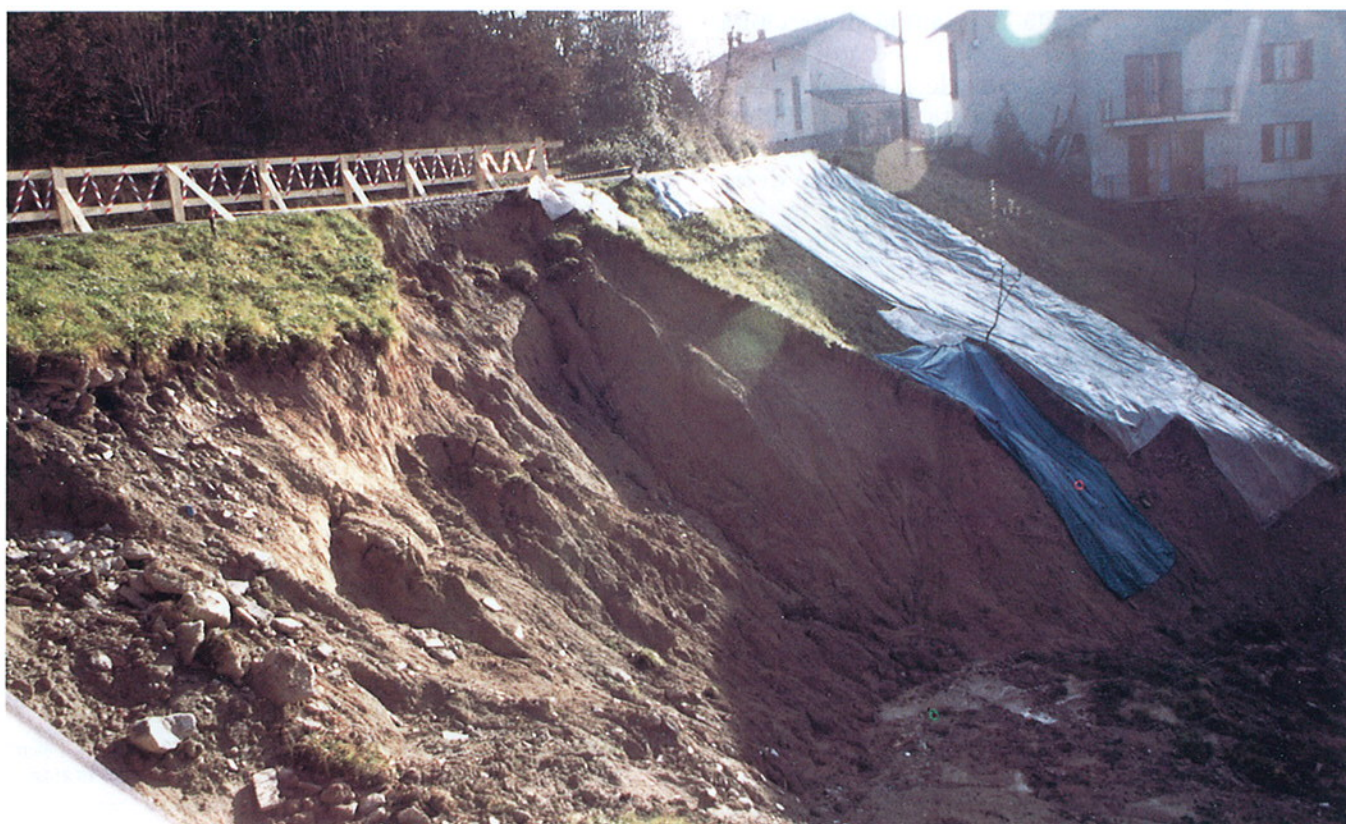
Fig. 33. Comune di Biella, loc. Bogna: frana innescatesi sul ciglio di valle della strada, con asportazione di parte della carreggiata. Tipologia di frana ricorrente, generalmente imputabile a problemi di smaltimento delle acque di ruscellamento.
