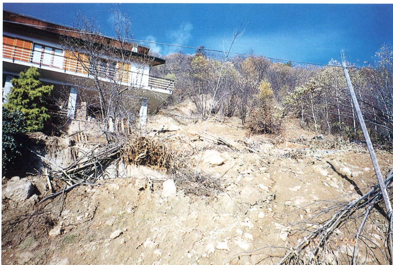
Fig. 22. Comune di Prascorsano, località Via Cerialdo. Ripresa dell'edificio lambito dalla colata di detrito.
