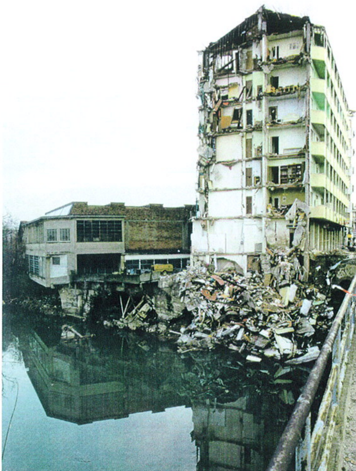
Fig. 23. Comune di Venaria, via Cavallo. Ripresa dell'edificio parzialmente crollato per sottoscalzamento delle fondazioni ad opera del t. Ceronda.
