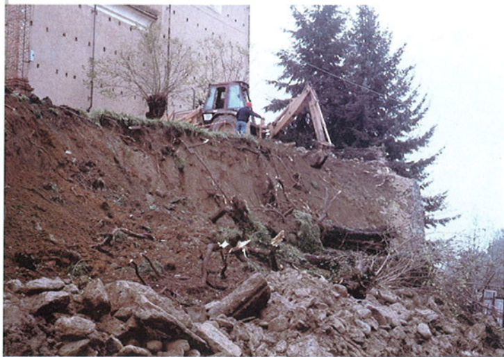
Fig. 42. Comune di Mongrando, loc. San Lorenzo: collasso del muro di sostegno del piazzale della Chiesa; il materiale franato ha interrotto la sottostante strada interrompendo l'accesso alla frazione.
