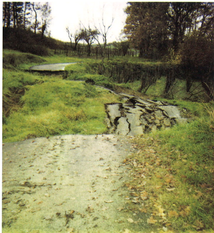
Fig. 12. Casasco, frazione Magrassi, novembre 1994. Dislocazione di sede stradale per riattivazione di colata.
