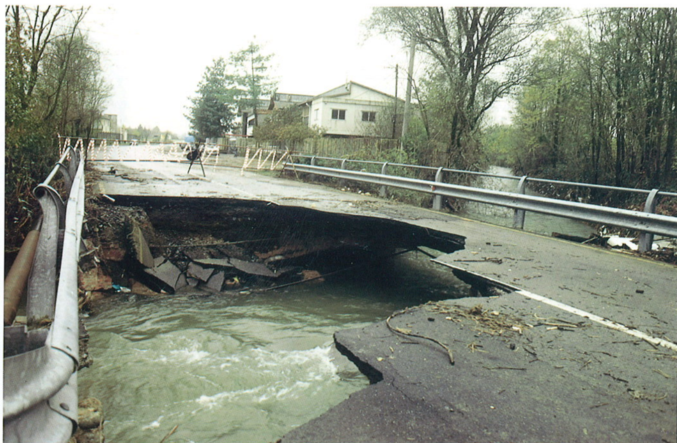
Fig. 24. Comune di Volpiano. Ripresa da Est dell'attraversamento sul t. Bendola, lungo la strada astatale tra Volpiano e Leinì, gravemente danneggiato dalle acque di piena del torrente.
