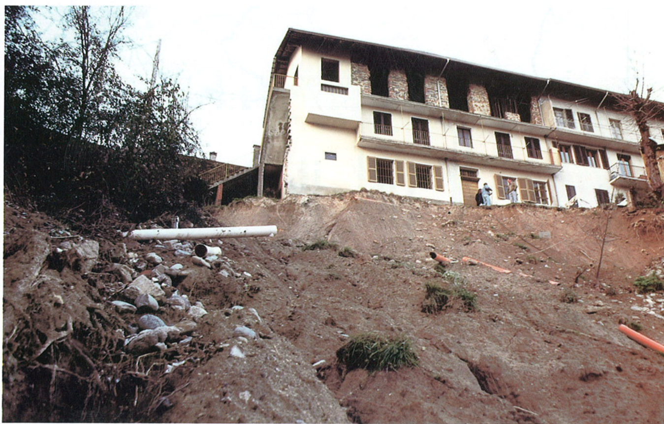
Fig. 35. Comune di Portula, loc. Scatolè: vista da valle della zona di distacco della frana al piede della casa; asportate le pertinenze e seriamente compromessa la stabilità dell'edificio. La mobilitazione dei rilevati artificiali è un fenomeno piuttosto ricorrente quando connesso a problemi di instabilità di aree prospicienti gli edifici.
