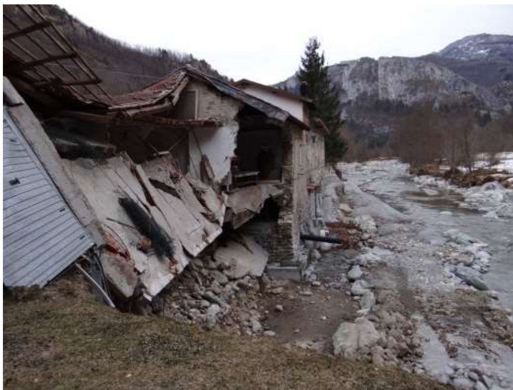
Figura 3. Erosione in sponda sinistra e crollo di un edificio, a monte di località Cantarana
