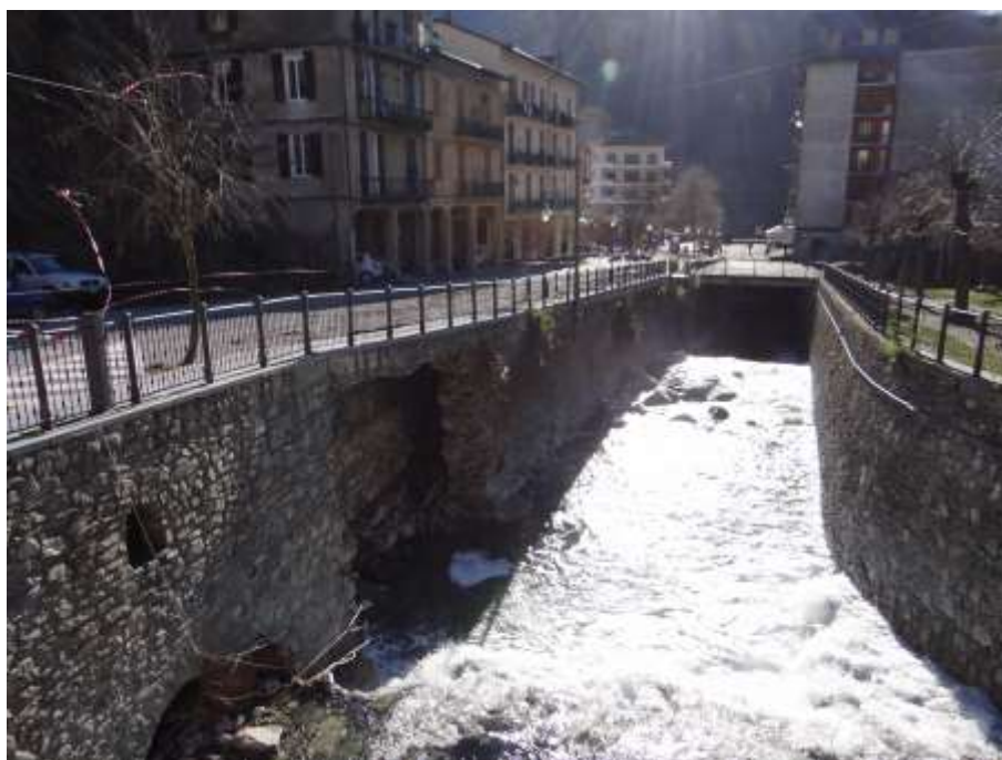
Figura 4. Ormea, muro d'argine sifonato in sinistra idrografica del Rio Armella
