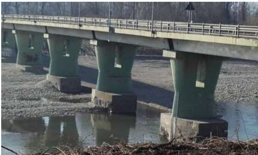
Figura 22. Il Ponte della SP 92 ha subito danni strutturali ad una pila e pertanto è stato chiuso al traffico
