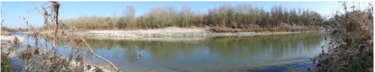
Figura 58. Antignano - Erosione spondale in destra idrografica
