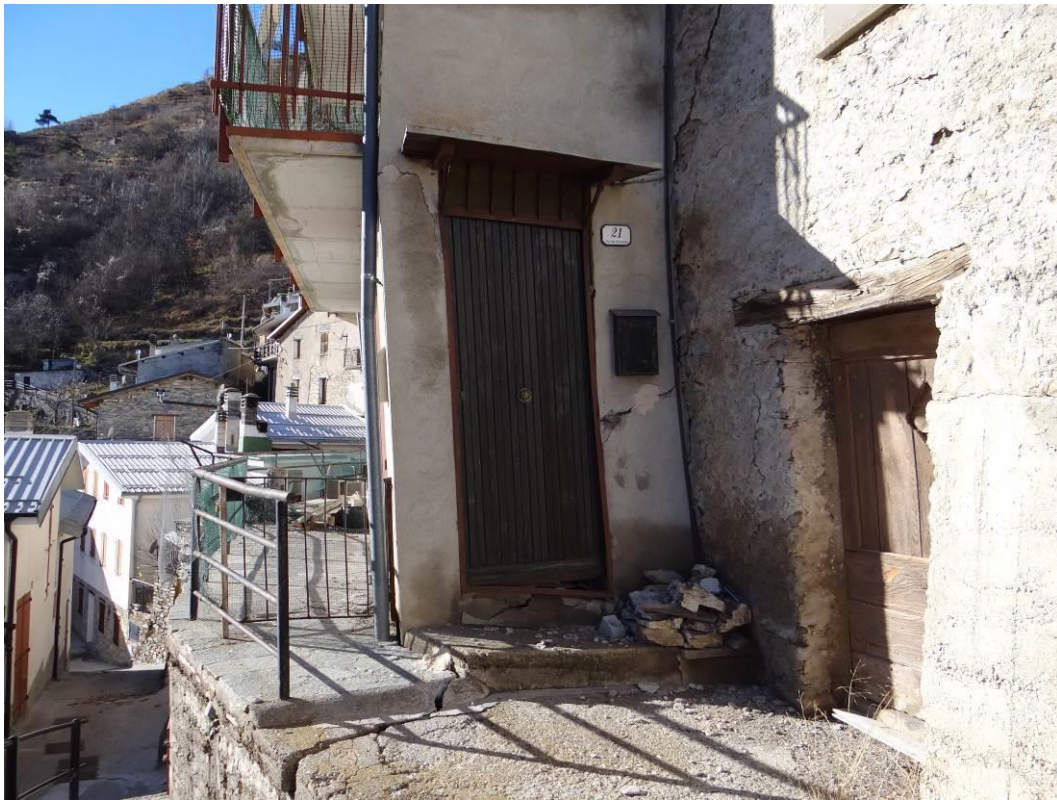
Figura 20. Edificio pesantemente deformato dalla spinta a tergo della frana di Piaggia; fotografia scattata il 29 novembre 2016
