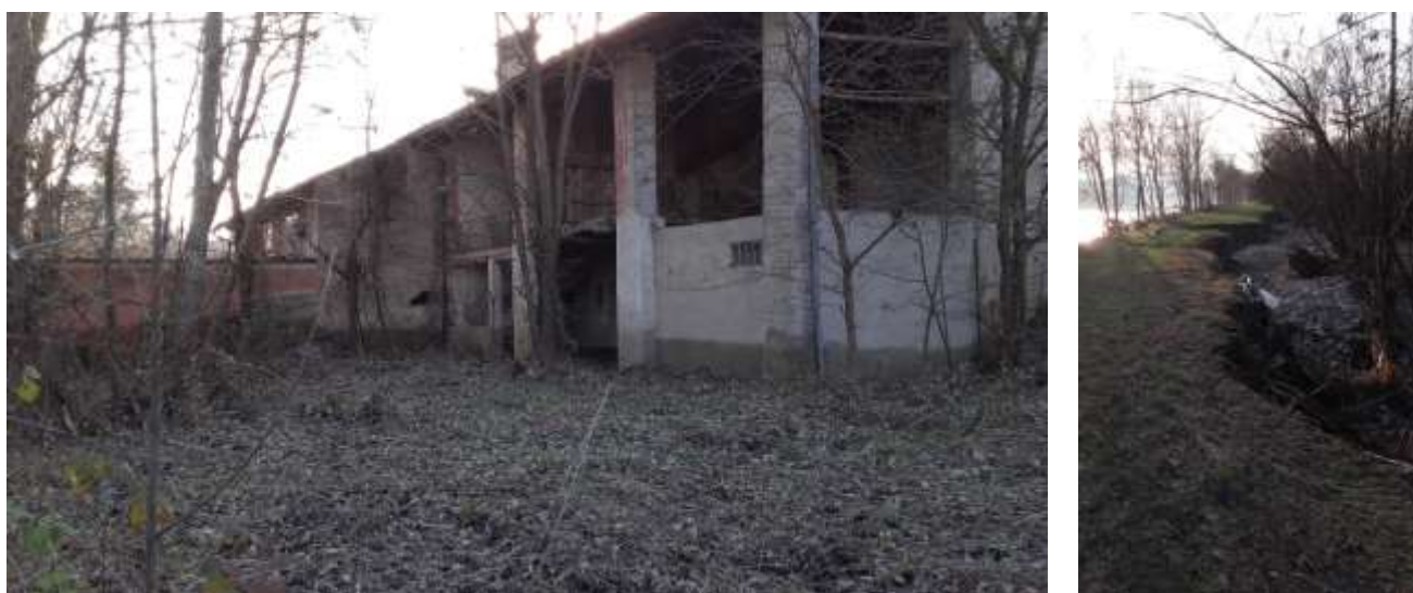
Figura 44. Carrù (località L'Arcurata) – a sinistra, sulle pareti dell'edificio sono visibili i segni dell'inondazione, a destra Segni di erosione sul rilevato arginale
