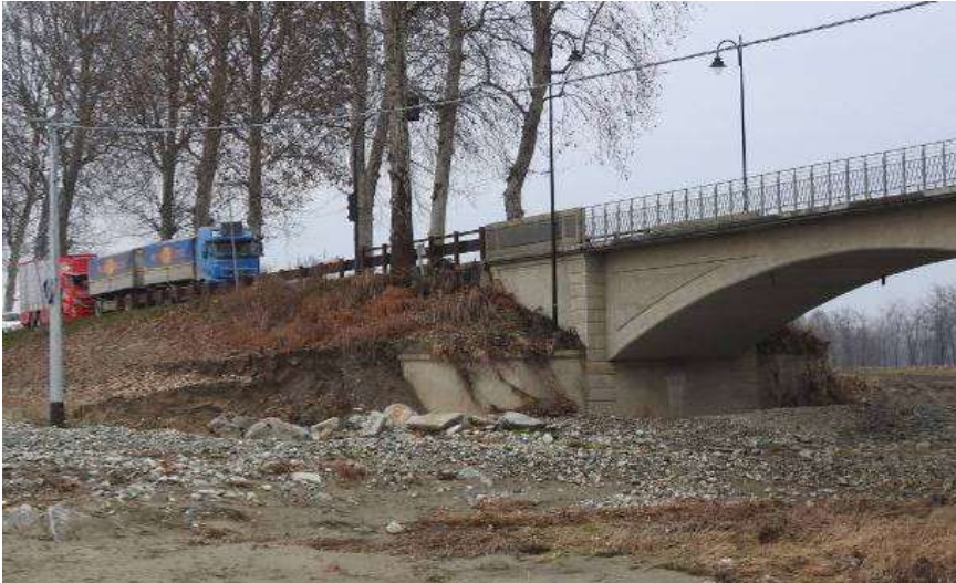
Figura 2. erosione rilevato sponda sinistra a Cardè
