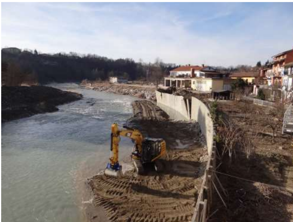
Figura 26. Ceva, difese spondali, in destra idrografica, danneggiate a valle del ponte della SS28
