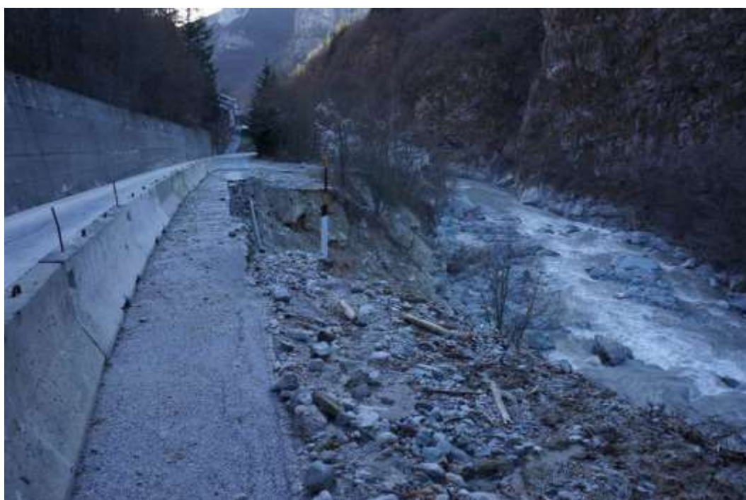
Figura 2. Erosione in sponda sinistra, poco a monte dell'abitato di Ponte di Nava
