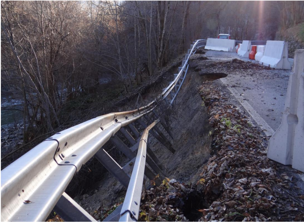
Figura 8. Pamparato, loc. Curto; erosione spondale, danni alla provinciale di fondovalle. Fotografia scattata il 30 novembre 2016
