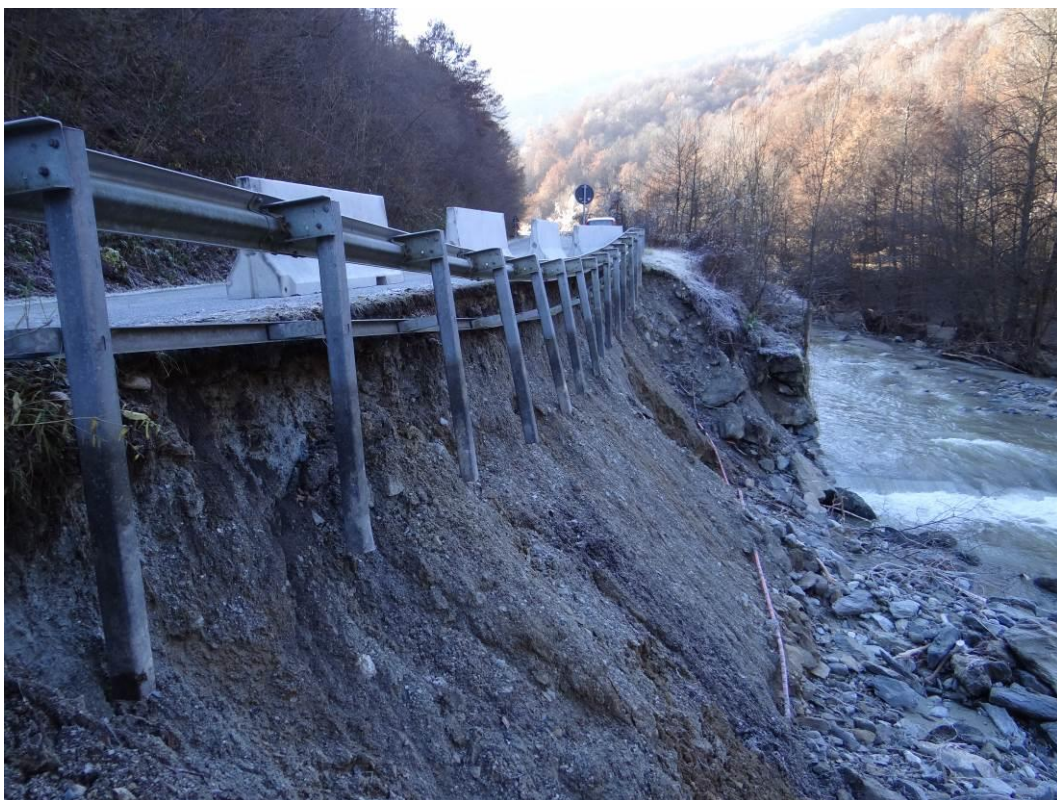
Figura 11. Monasterolo Casotto, loc. Costacalda; erosione spondale, danni alla provinciale di fondovalle. Fotografia scattata il 30 novembre 2016
