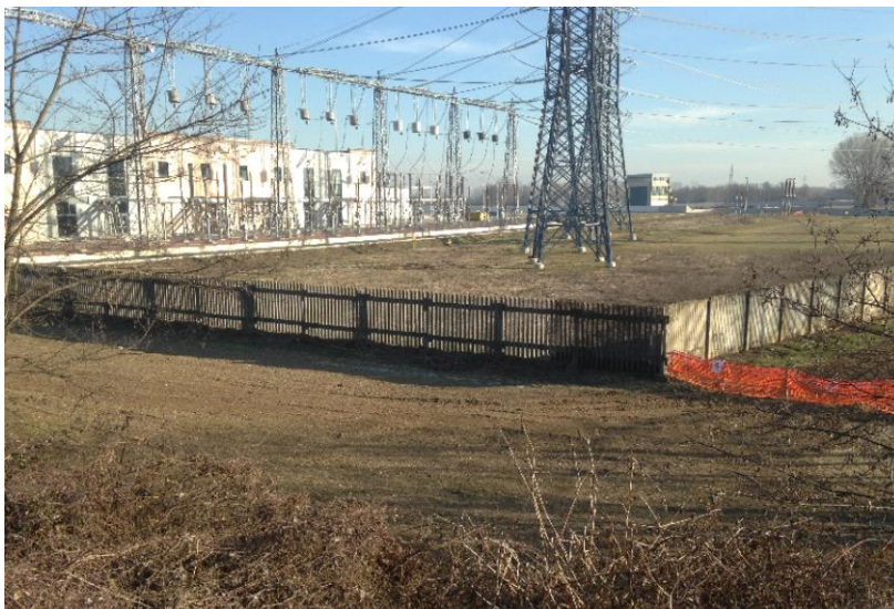
Figura 3. Comune di Piossasco, centrale Terna; aree verdi coinvolte nella dinamica dei deflussi e stazione elettrica, rialzata, non interessata dagli allagamenti
