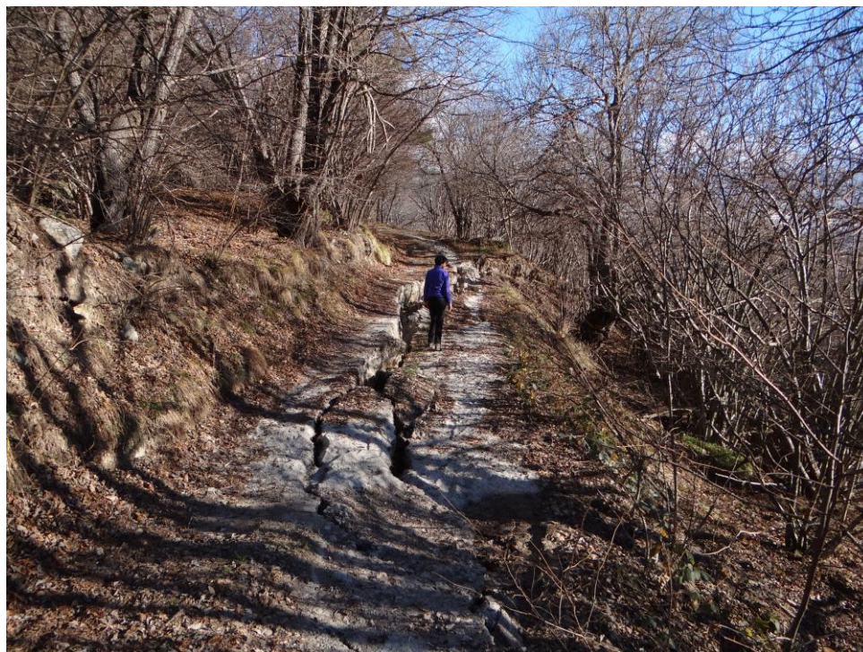
Figura 3. Ormea (CN), loc. Pornassino - 14.12.2016. Evidenze morfologiche dei movimenti occorsi a seguito dell'evento
