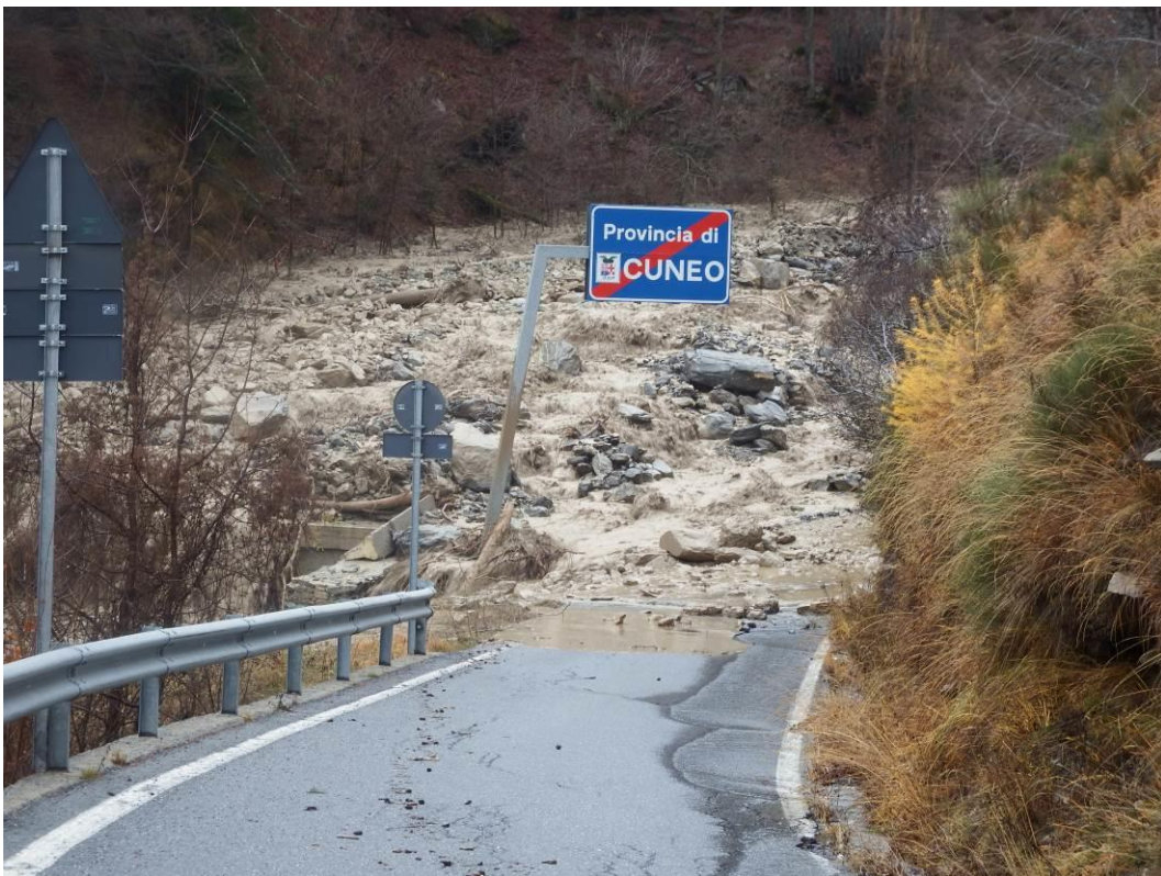
Figura 13. Violenta attività torrentizia lungo il Bavera al confine ligure-piemontese; fotografia scattata da Piersandro Airone il 24 novembre 2016
