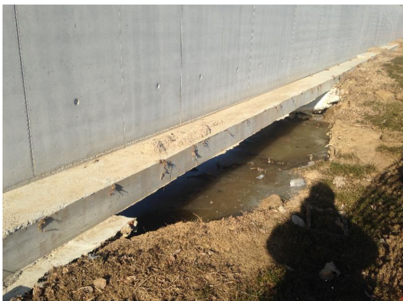
Figura 4. Comune di Piossasco; tratto di muro di recinzione della centrale Terna sifonato
