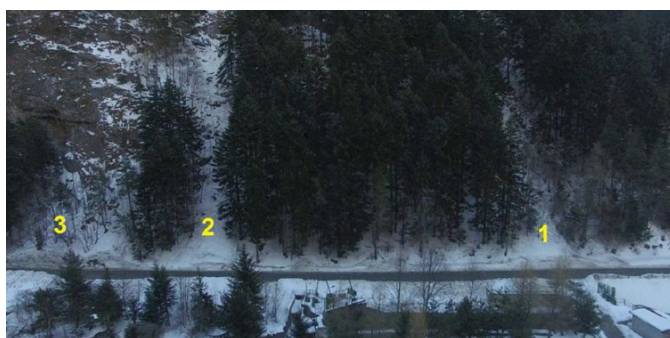
Figura 4.7: vista panoramica del versante interessato dai 3 distacchi che hanno coinvolto la SP422 (foto della CLV scattata il 21 dicembre).
