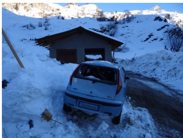
Figura 4.7: Struttura investita dalla valanga e auto danneggiata.
