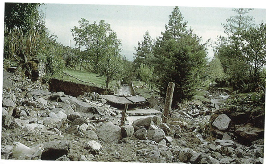
FOTO 80 - Comune di Envie. Le acque del Rio Comba Grande nel corso della piena hanno abbandonato l'alveo ordinario (sulla destra) incanalandosi lungo la strada ad esso parallela e depositando materiale grossolano sulla strada per Envie.
