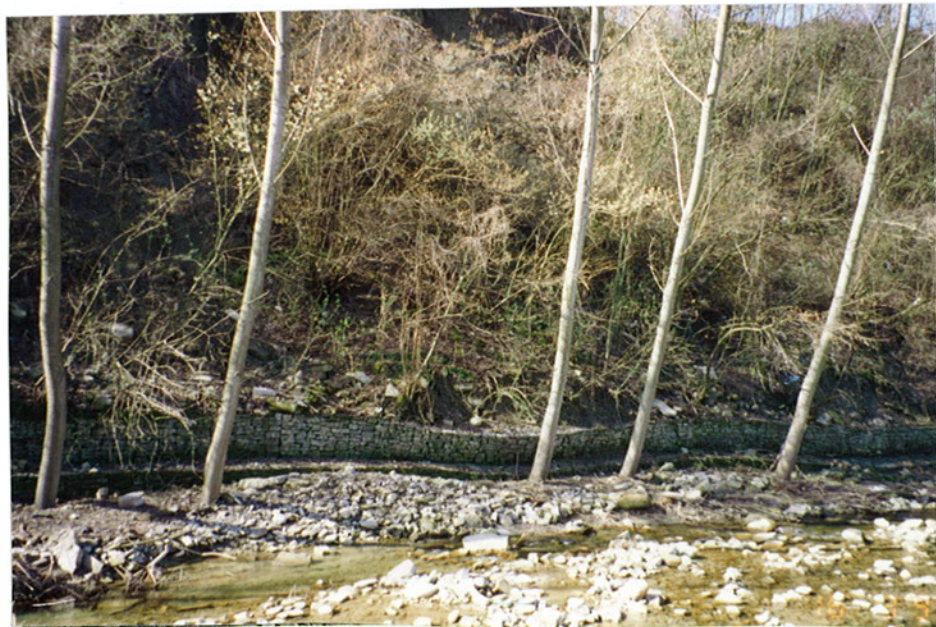
FOTO 81 - Comune di Perletto (CN). Gabbionate scalzate al piede con innesco di una frana nella scarpata sulla sinistra del Rio Tatorba in località Cascina Bormiotti.
