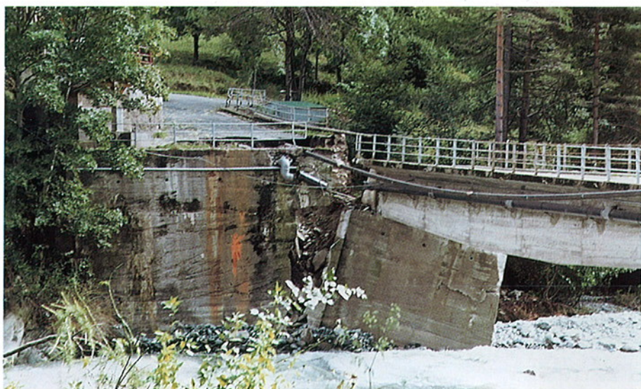
FOTO 35 - Valprato Soana (TO), ponte per la frazione Zurlera, gravemente danneggiato per disarticolazione della spalla sinistra.
