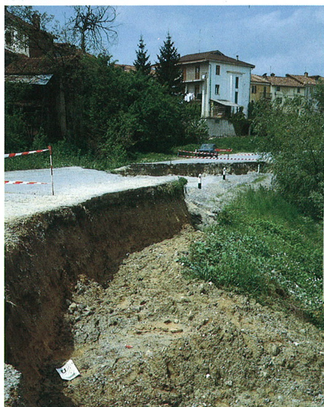
Fig. 36, 36 bis. Parte sommitale del corpo di frana: configurazione caratteristica determinata da sollecitazioni che inducono un movimento di tipo rotazionale lungo superfici di scivolamento concave.
