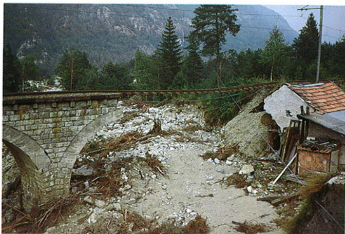
Fig. 50. Ponte ferroviario distrutto in seguito ad una piena straordinaria provocata da un evento alluvionale di particolare intensità.
