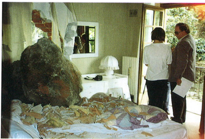
Fig. 30. Effetti indotti su di un edificio dalla caduta massi instabili staccatisi da una parete rocciosa. La foto pone in evidenza come crolli di porzioni rocciose quantunque limitate ma in grado di percorrere attraverso fenomeni di proiezione, rotolio e rimbalzo notevoli tragitti, possono risultare particolarmente pericolosi.
