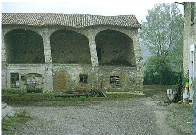
Fig. 52. Danni ai centri abitati: evidenti lesioni ad un fienile provocate da un fenomeno franoso.
