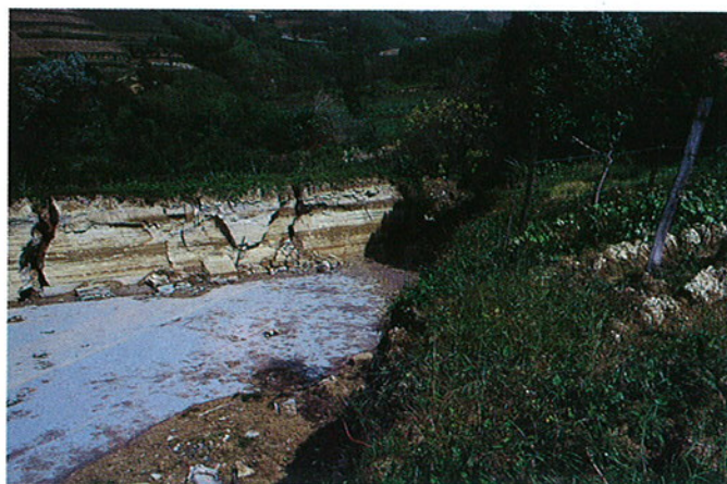
Fig. 33. La foto pone in evidenza un tipico scivolamento planare avvenuto lungo la superficie di strato ben visibile al centro dell'immagine. Le zolle traslate conservano integre le loro caratteristiche strutturali.
