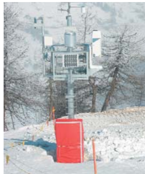
Figura 2.41 - Stazione fissa di misura presso Sestriere Alpette
