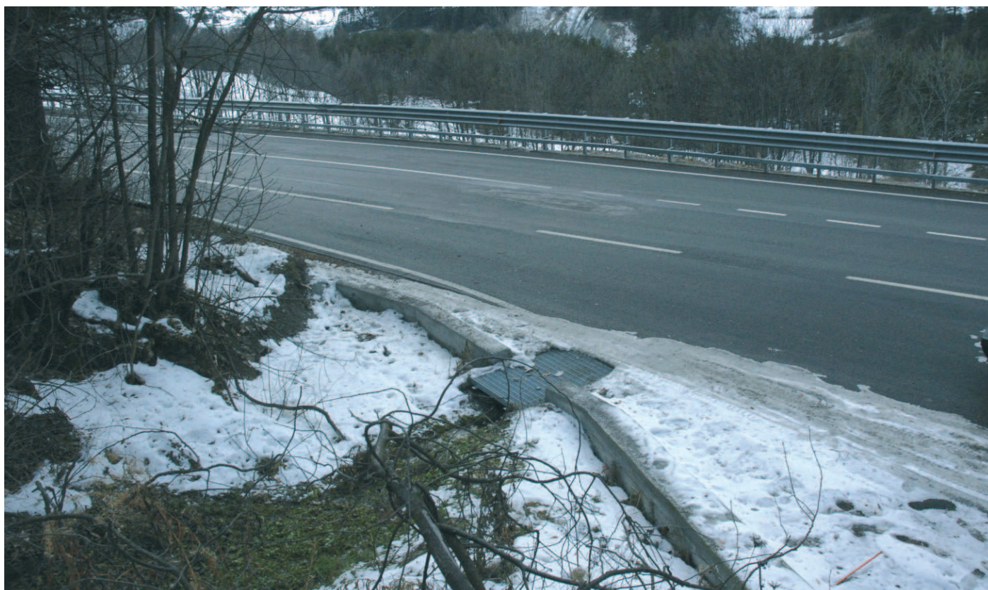
Fig. 12 - Tombino di scolo dell'acqua la cui chiusura ne impedisce l'utilizzo come sottopasso per la piccola fauna e causa l'intrappolamento degli animali
