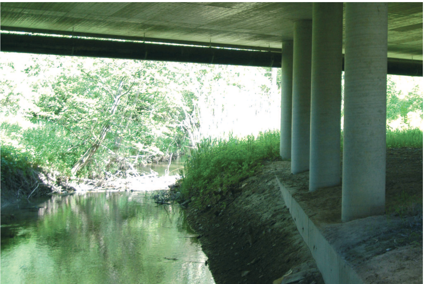
Fig. 35 - Sottopasso misto per la fauna e per il passaggio di acque superficiali
