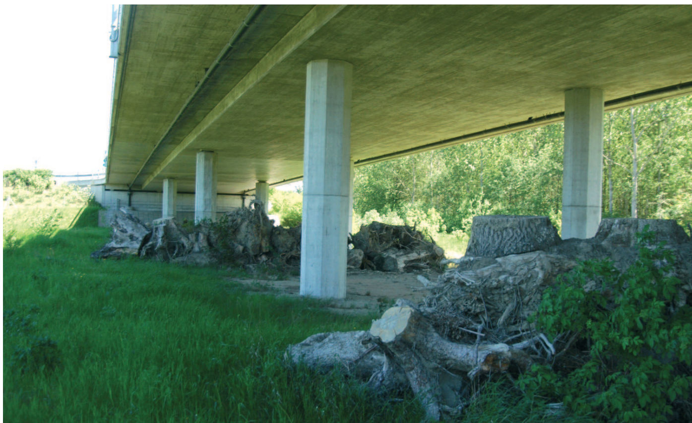
Fig. 25 - Particolare della disposizione delle file di ceppi sotto il viadotto per ripristinare il corridoio ecologico interrotto
