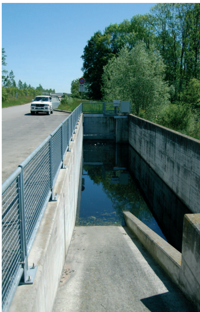
Fig. 21 - Particolare della vasca di prima pioggia con sedimentatore per olii che precede il bacino
