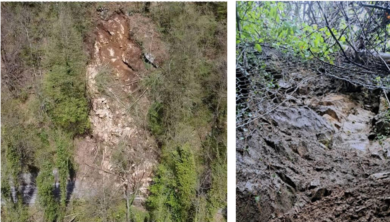
Figura 51 - A sinistra il crollo che ha coinvolto la SP 52 della Val Strona al km 8+400; a destra, i danneggiamenti dei rivestimenti antierosivi sulla strada provinciale per Cicogna (foto geologo Regione Piemonte - Provincia VCO).
