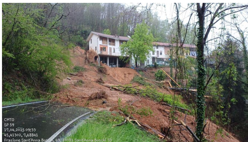
Figura 47 - Castellamonte, Frana sulla SP 59 a Sant'Anna dei Boschi, frazione di Castellamonte (Foto: Città Metropolitana di Torino, Pagina Facebook).
