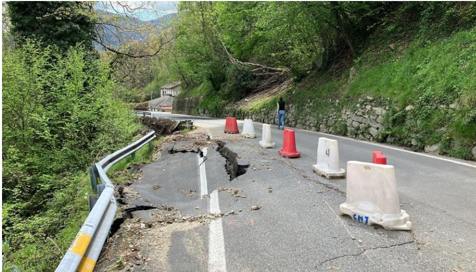
Figura 48 – SP 47 della Val Soana danneggiata al km 3 per il cedimento della sede stradale.
