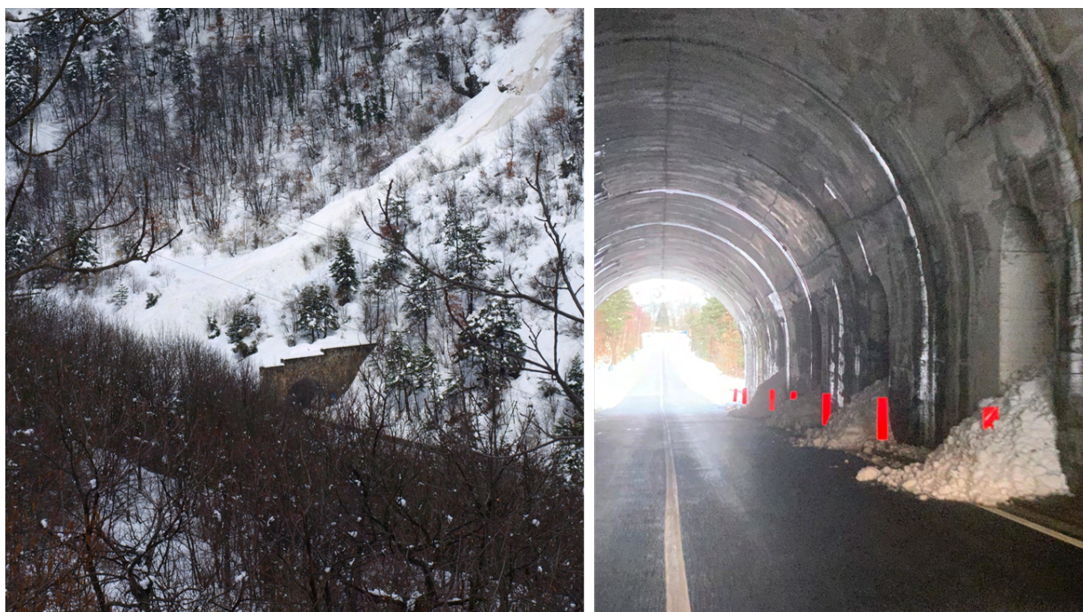
Figura 4.26: Sulla sinistra è visibile la zona di accumulo della valanga (codice SIVA: 01 L CN) che ha interessato la SS del Colle della Maddalena protetta dal paravalanghe denominato “Buoina”; sulla destra l'accumulo che è entrato dalle aperture di valle del paravalanghe. Foto effettuata durante i sopralluoghi svolti dalla CLV Valle Stura
