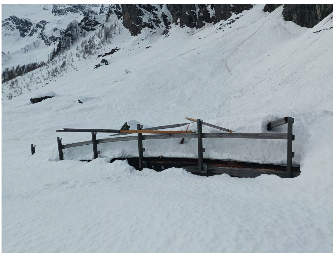
Figura 4.16: Dettaglio sul ponte divelto presumibilmente ad inizio marzo 2024
