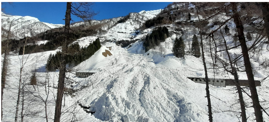
Figura 4.21: La "valanga del Pissone", codice SIVA: 04 B VC, (Carcoforo, VC) che ha coperto quasi completamente la galleria paravalanghe (foto CLV Val Sesia)
