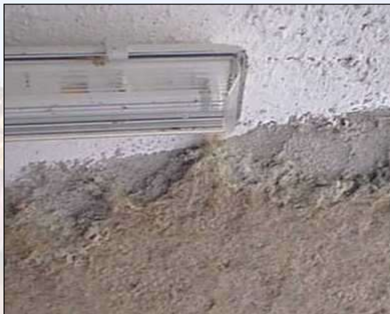
1. Grunerite d'amianto spruzzata: manufatto in opera
