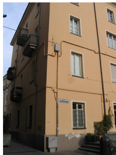
b) linee BT su facciata edificio
