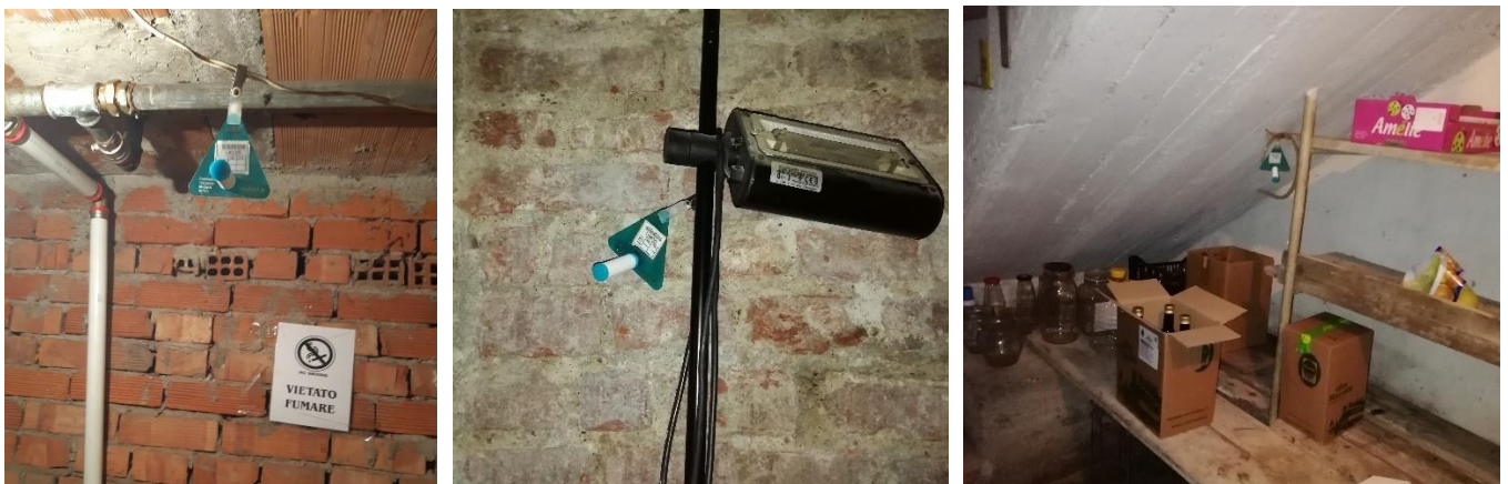
Campionatori passivi alloggiati all'interno dei locali interrati di Spinetta Marengo
