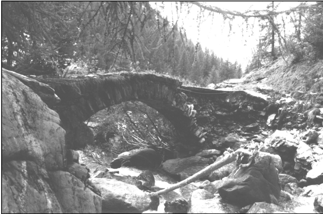
Fig. 26 Comune di Riva Valdobbia. Val Vogna. Il ponte napoleonico danneggiato dalla piena del settembre 1993.
