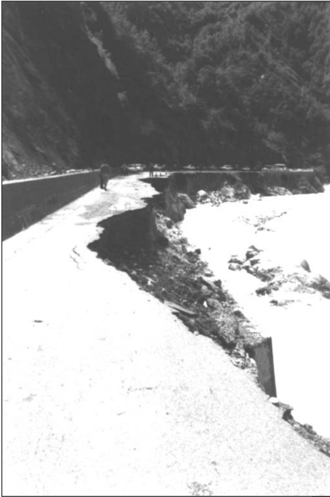
Fig. 21. Comune di Cravagliana. La strada di Val Mastallone di fronte alla frazione Voy.
