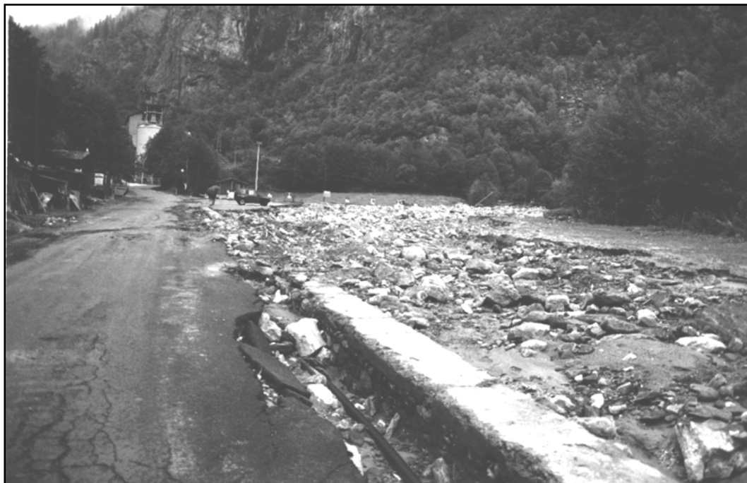
Fig. 24. Comune di Alagna. Frazione Merletti. Il parcheggio dell'impianto sciistico Wold eroso dalle acque in piena della Sesia.
