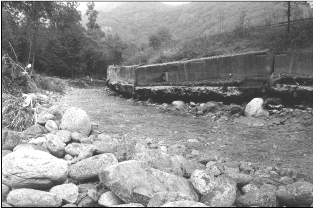
Fig. 30. Comune di Varallo. Lo svincolo della tangenziale, al Baraggiolo, eroso dal fiume.
