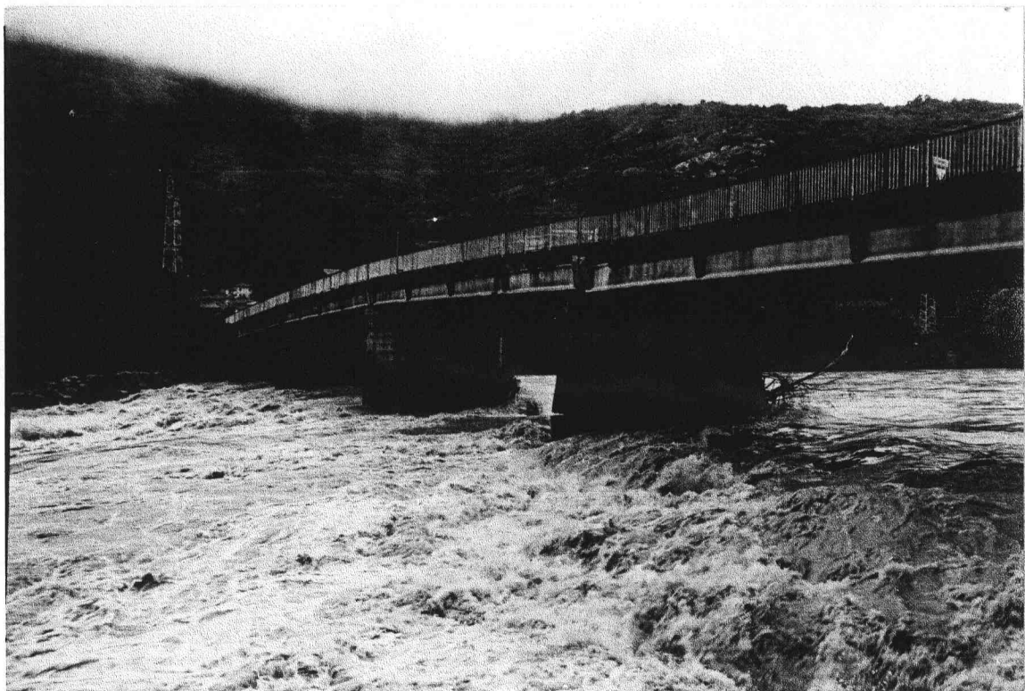
Fig.2 - Ponte di Quassolo: pila scalzata per accentuata erosione di fondo.
