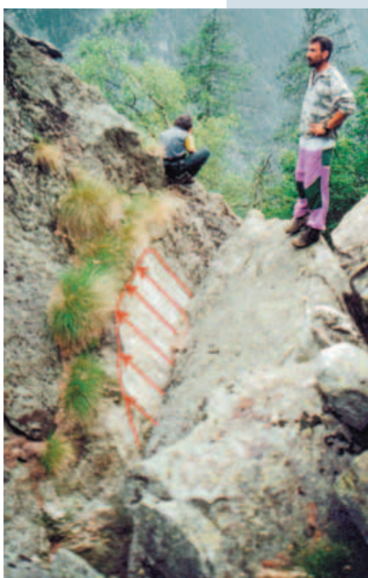
Figura 3.25 ♦ La dislocazione osservabile sulla fotografia, circa 70 cm di abbassamento del comparto a destra, si è sviluppata a seguito delle piogge del maggio-giugno 2002 (foto G. Bossalini).
