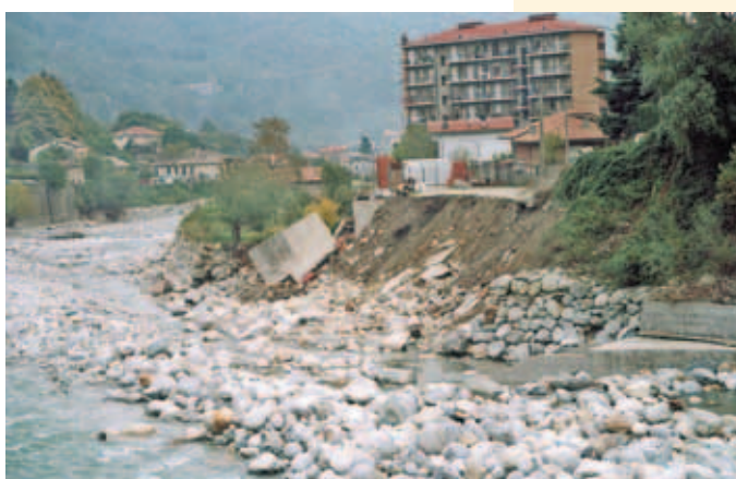
Figura 2.74 ◆ Pont Canavese, capoluogo: il torrente Soana ha asportato un tratto di scogliera in destra ed, erodendo la sponda retrostante, ha provocato il franamento di un'area adibita a deposito edile.
