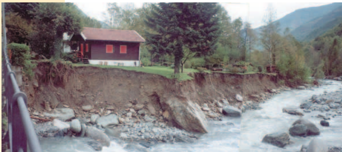
Figura 2.133 ◆ Bobbio Pellice. Ponte Payant. L'erosione in sponda sinistra provoca un vistoso arretramento del ciglio, con minaccia per un edificio posto a pochi metri di distanza
