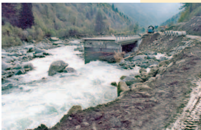
Figura 2.73 ◆ Ronco Canavese, confluenza con il rio Guardia: ampia erosione di sponda con asportazione di un tratto della strada provinciale.
