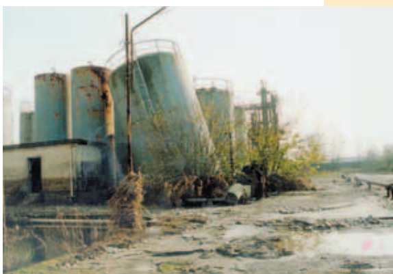
Figura 2.171 ♦ Coniolo, Loc. Florida. Cisterne del complesso industriale "ex Maura" con evidente danneggiamento, solchi di erosione e presenza di materiale fluitato indicante l'ordine di grandezza del battente d'acqua raggiunto.
