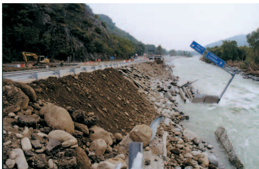
Figura 2.66 ♦ Pont Canavese, S.S. 460, loc. bivio per la Val Soana: vista da monte dell'apertura di un nuovo canale con erosione della massicciata stradale.
