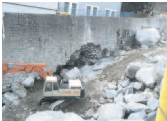
Figura 2.57 ◆ Locana, loc. Rosone: particolare del muro di difesa della centrale A.E.M., in destra Piantonetto, profondamente sottoescavato, il cui abbattimento avrebbe potuto consentire alle acque di piena di invadere una consistente parte del centro abitato di Rosone.
