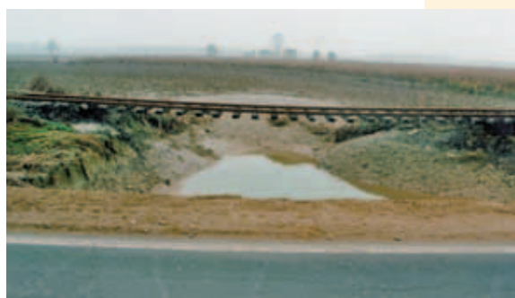
Figura 2.172 ♦ Casale M.to, Loc. Terranova. Sifonamento del rilevato ferroviario linea F.S. Casale- Mortara a lato S.S. 31 bis
