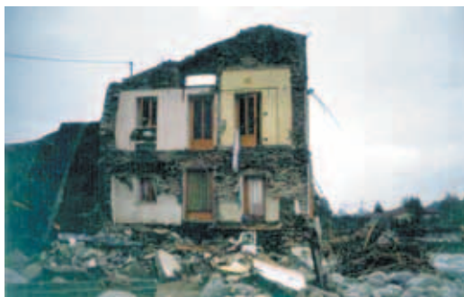
Figura 2.75 ♦ Comune di Cuorgnè. Località Salto Canavese. Torrente Orco. La progressione dell'erosione laterale sinistra ha raggiunto un'area urbanizzata da case sparse provocando la distruzione di un edificio. Parte della corrente ha raggiunto questo luogo "in rientro", ovvero con direzione dai piani agricoli verso l'alveo originando, nella lunata, curiose forme tipo "demoiselles coiffées" a carico dei depositi grossolani del basso terrazzo alluvionale.
