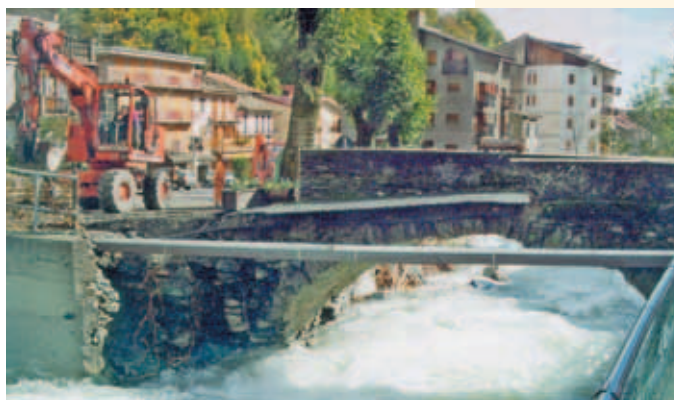
Figura 2.146 ◆ Comune di Crissolo, capoluogo. Il Po determina gravi danni al ponte ad arco in pietra, in seguito abbattuto.
