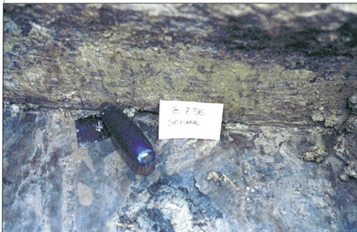
Fig. 54. Aspetto in affioramento del piano di scivolamento (frana di Cascina Valanche in Somano). La superficie di scivolamento è interposta a due strati marnosi in corrispondenza di un livello R di consistenza plastica. Tale livello destrutturato e rammollito si lascia facilmente infiggere dalla cazzuola (scarpata principale).
