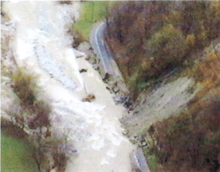
Fig. 11. Comune di Frabosa Soprana, località Corsaglia. L'immagine, tratta da ripresa aerea, mostra la strada provinciale di fondovalle asportata da erosione laterale del torrente Corsaglia. Il processo ha ulteriormente riattivato il movimento franoso di versante già presente a monte del manufatto.
