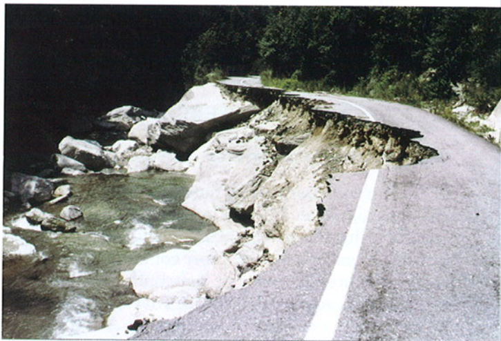
Fig. 15. Torrente Casotto. Ripresa dei gravissimi danni sofferti dalla strada provinciale di fondovalle a seguito delle violente erosioni spondali.
