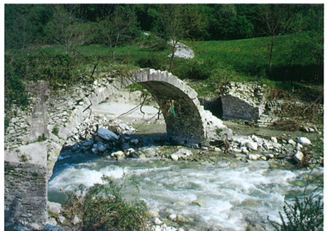
Fig. 13. Torrente Corsaglia, località Ponte Soprano. I resti dell'antico manufatto dopo il passaggio della piena del 5 novembre 1994.
