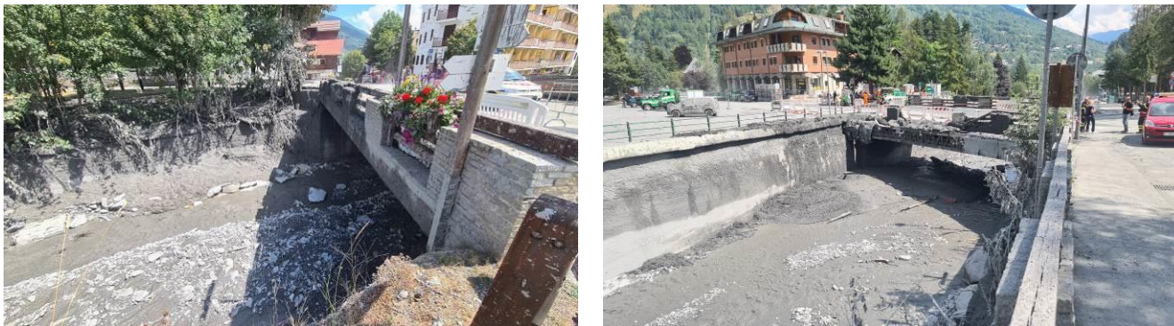
Figura 22 – Il ponte di via Medail (a sinistra) e quello di Piazza Alcide de Gasperi (a destra), parzialmente sormontati dalla parte liquida e più fine della colata.
