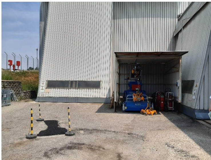
Figura 2 Area riasfaltata del piazzale (più scura e a forma di T, segnalata dai delineatori di margine).
